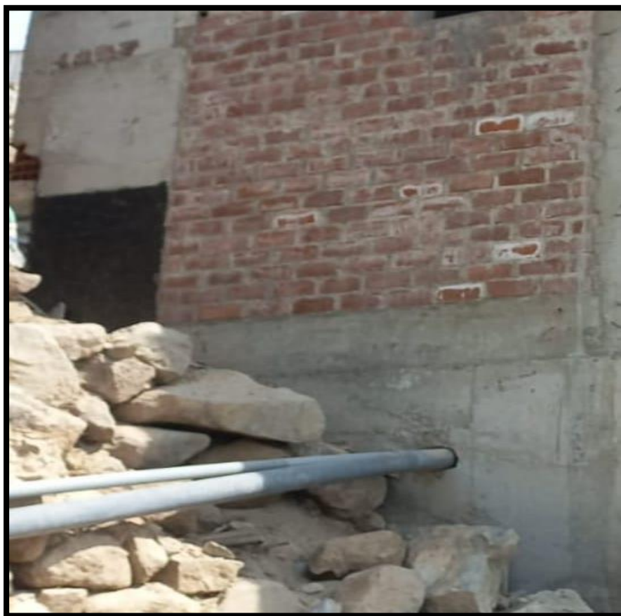
Figura 17. Cangrejas en los cimientos.
