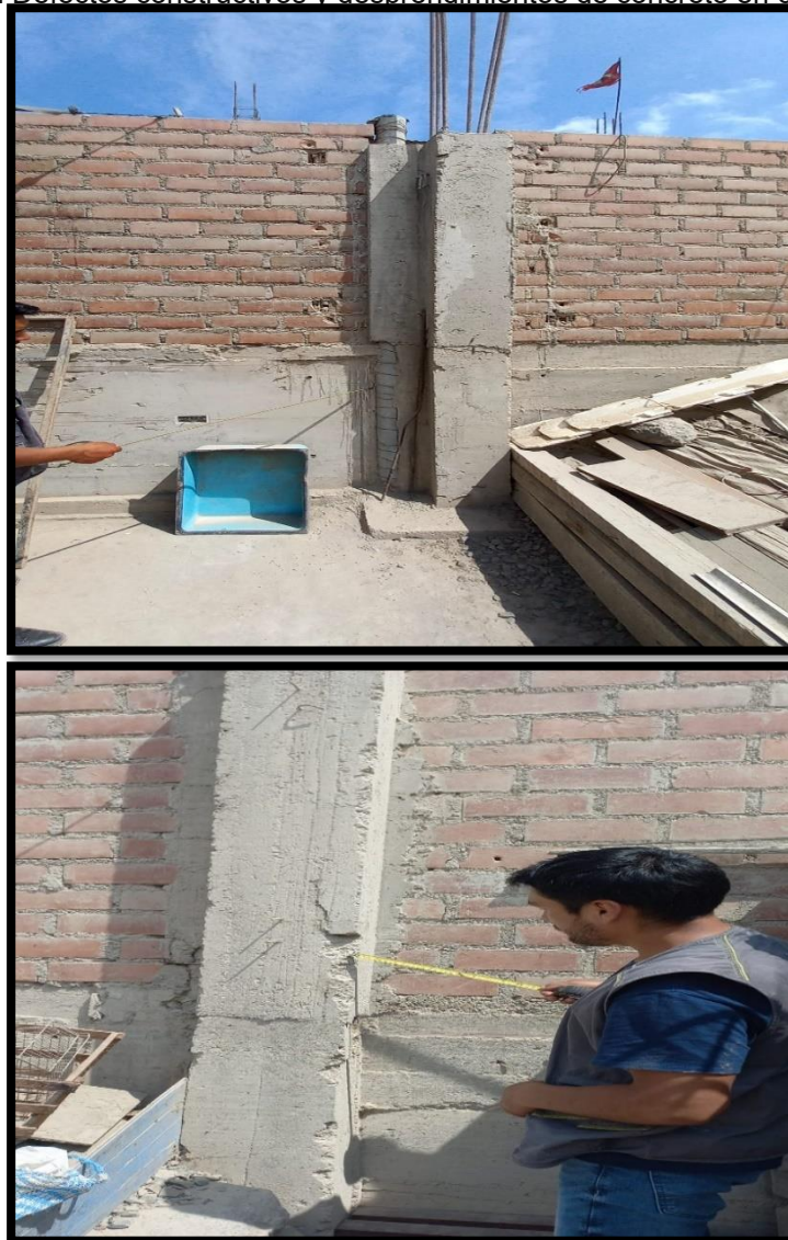
Figura 10. Defectos constructivos y desprendimientos de concreto en columnas.
