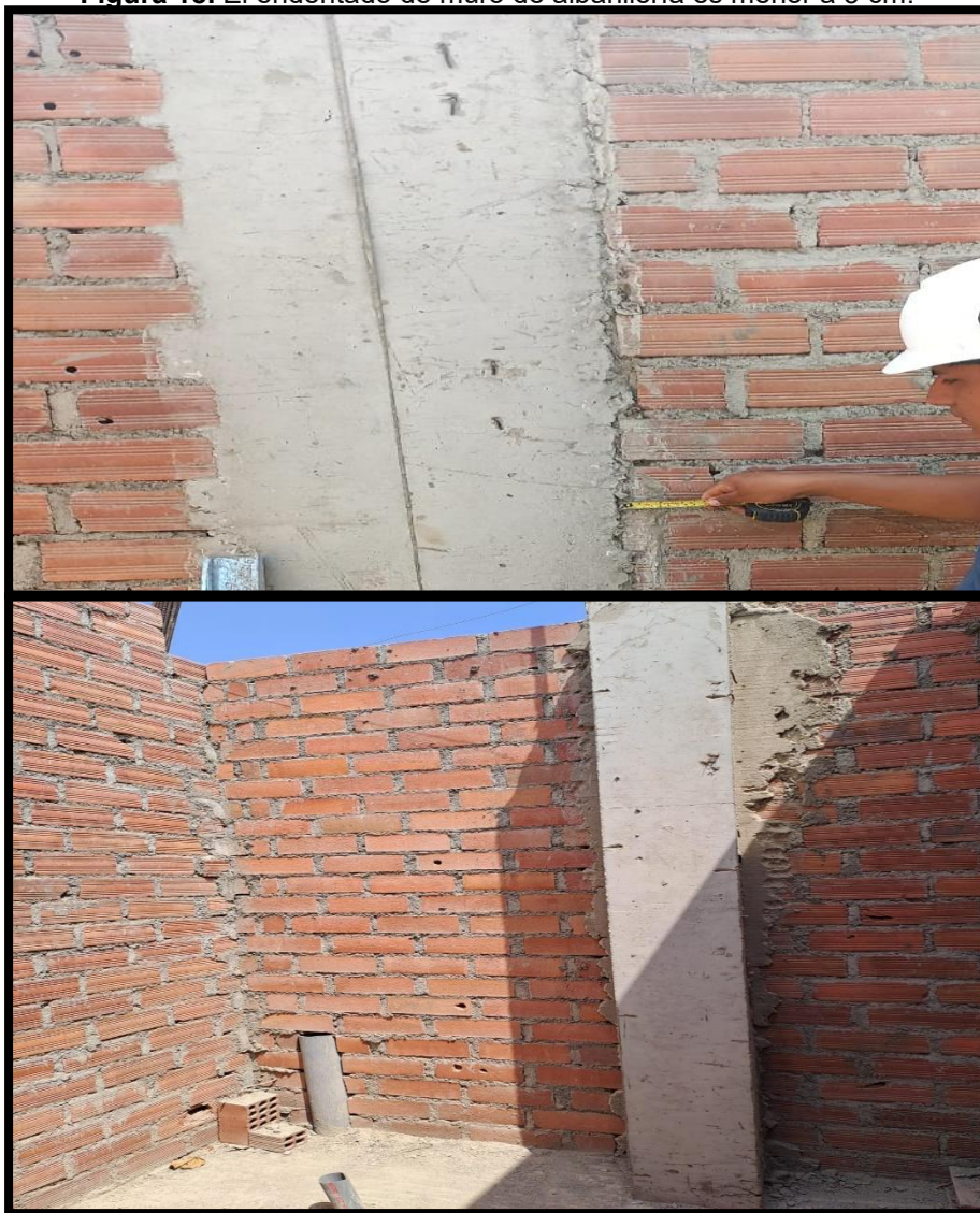
Figura 18. El endentado de muro de albañilería es menor a 5 cm.
