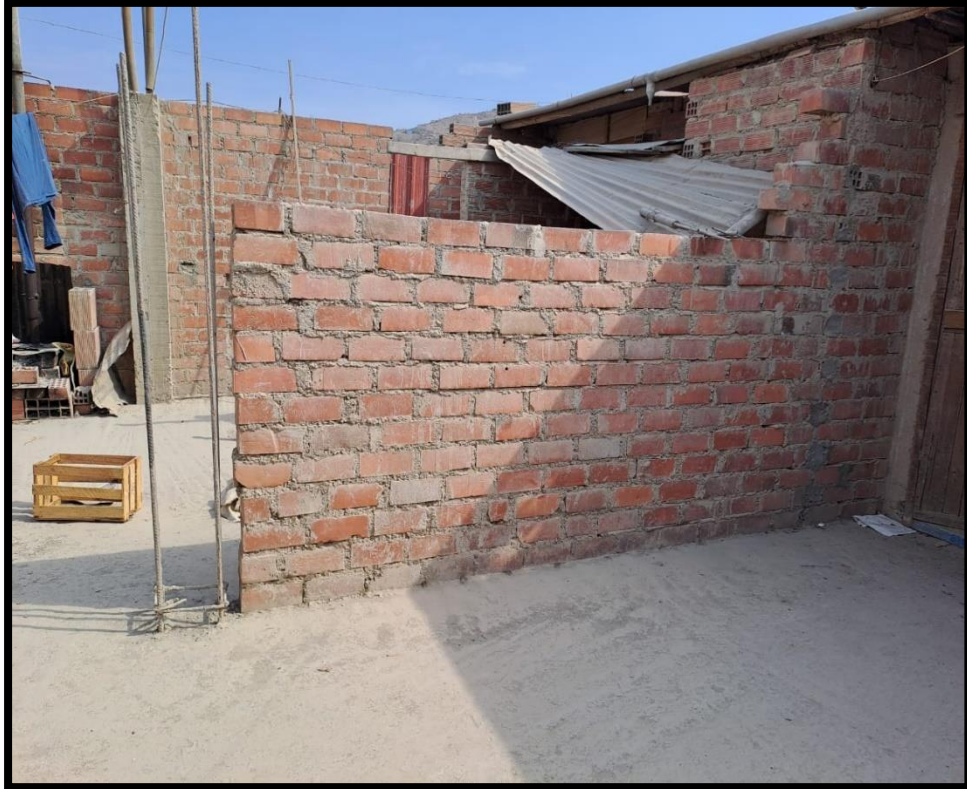
Figura 9. Muros de ladrillo sin endentado ni refuerzos verticales
