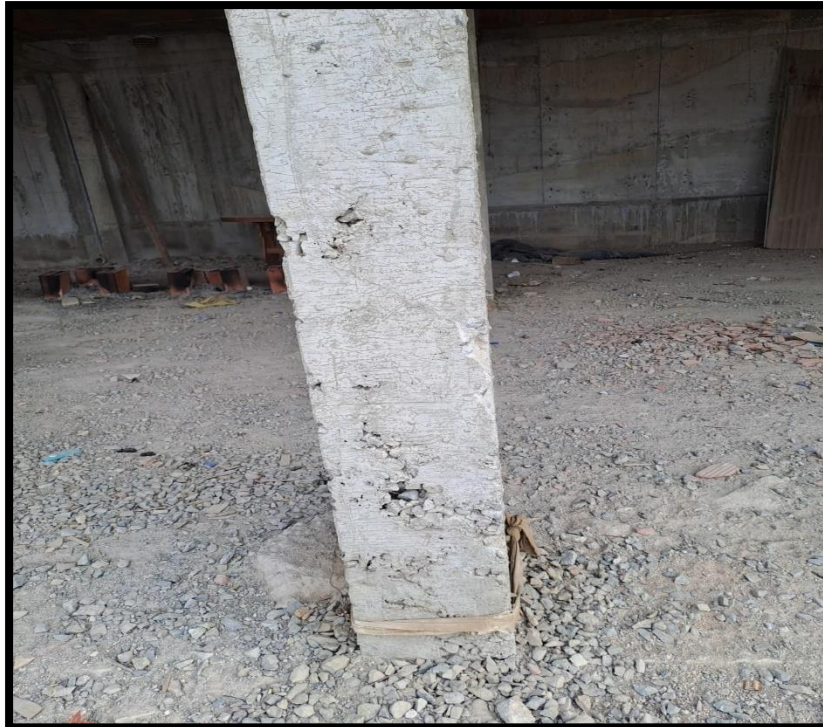
Figura 15. Cangrejeras en las columnas y vigas.
