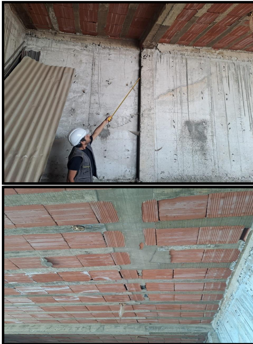
Figura 14. Cangrejas en las columnas y losa con exposición de aceros de refuerzo y corte de tubería de 2" en la losa.
