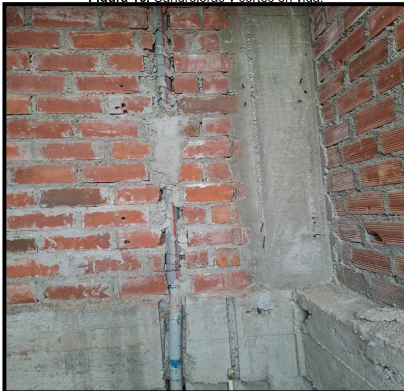
Figura 16. Cangrejeras y cortes en viga.
