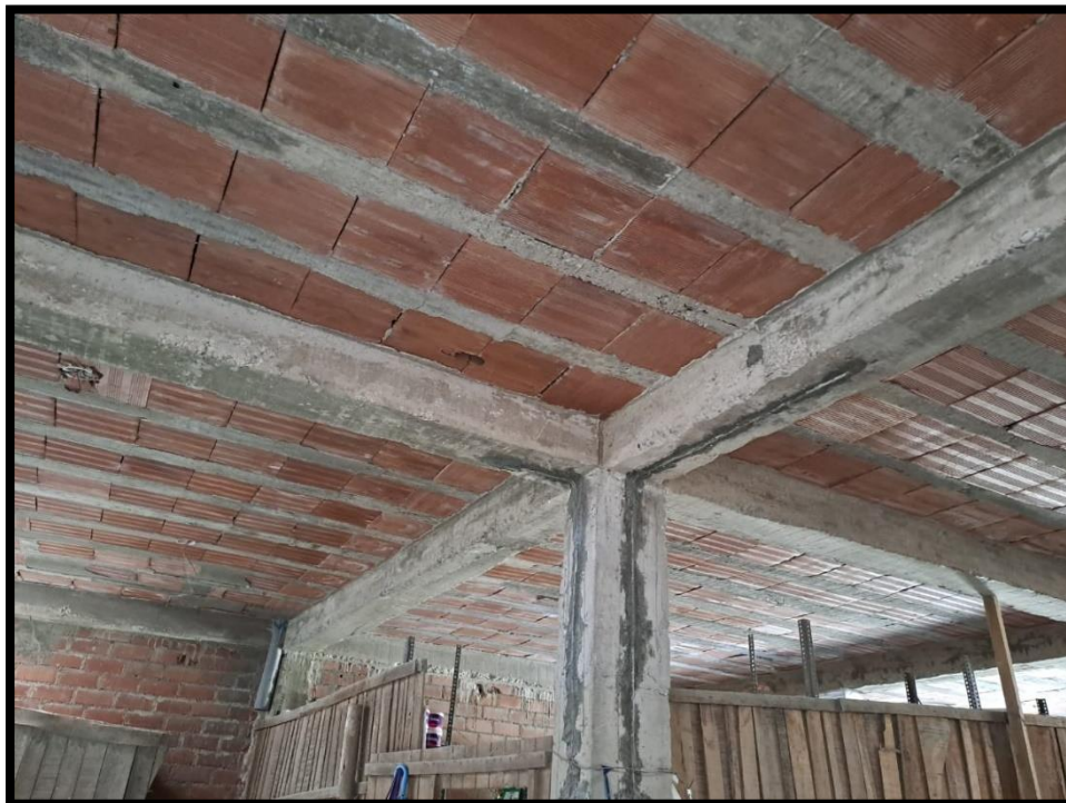
Figura 8. Cortes en las columnas para la instalación de tuberías y cangrejeras en las viguetas.
