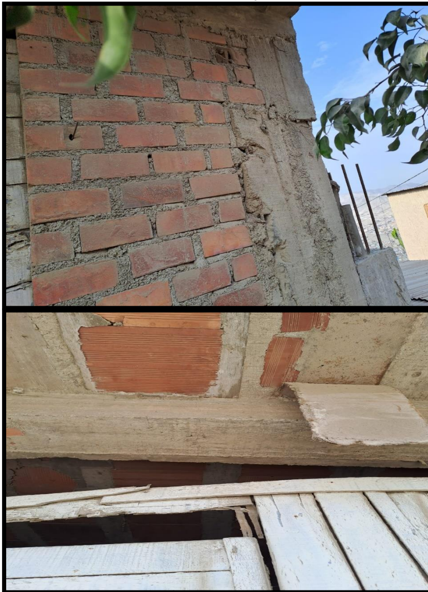
Figura 22. Agrietamiento en las columnas y fisuras en las vigas así mismo desprendimiento del concreto.
