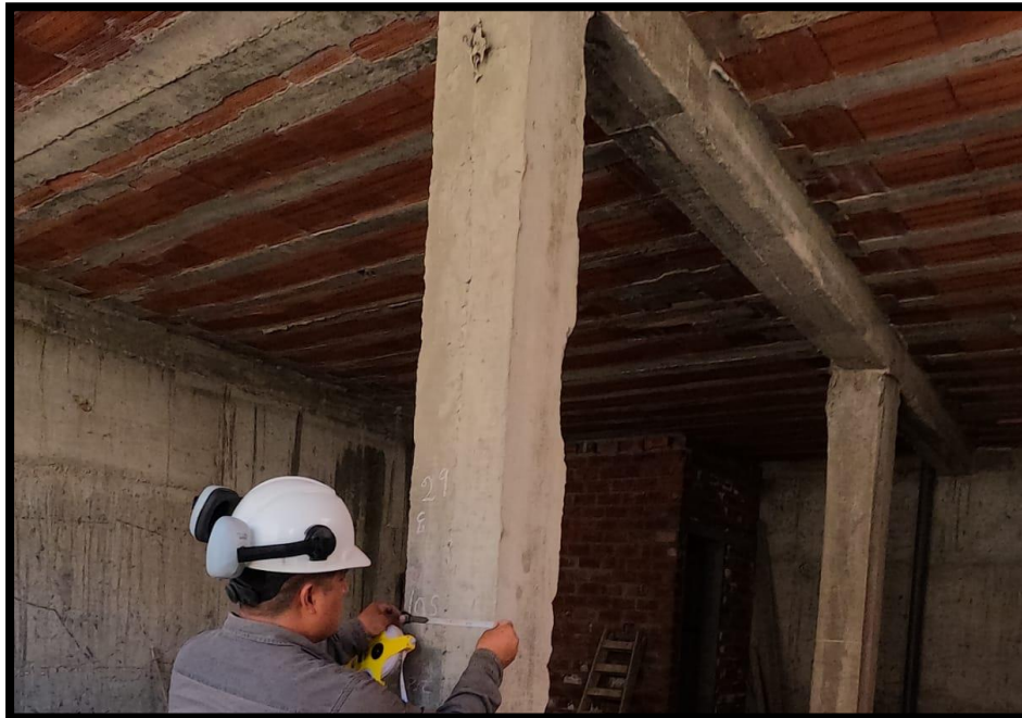
Figura 21. Desprendimiento de concreto en la columna central.
