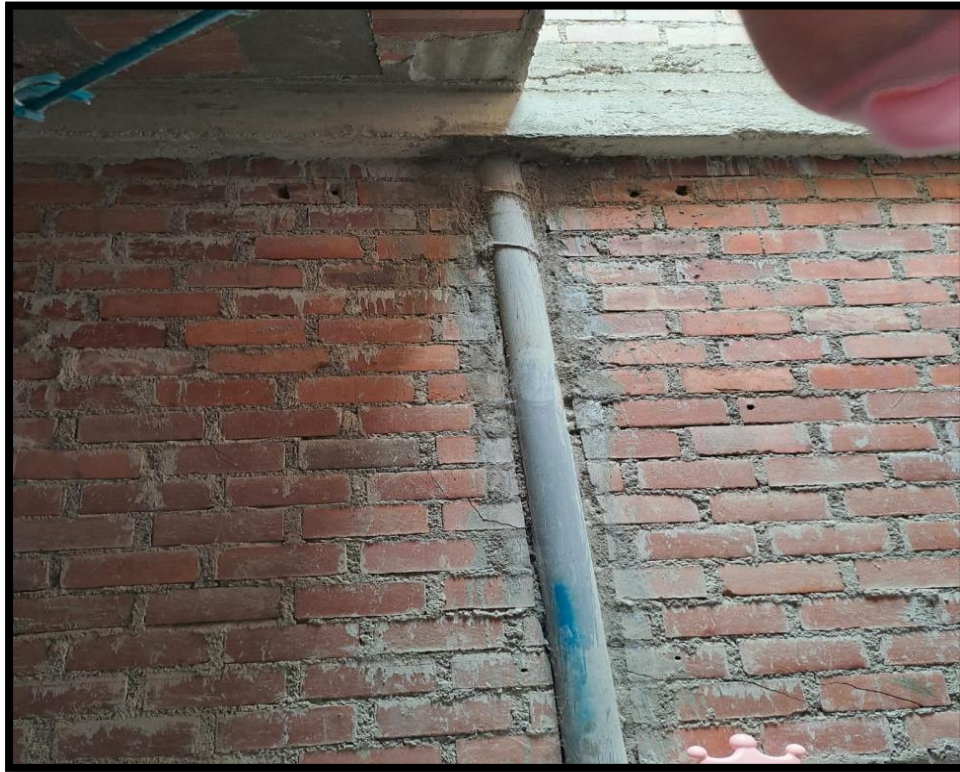
Figura 7. Tubería de desagüe de 4 pulgadas cortando los muros.
