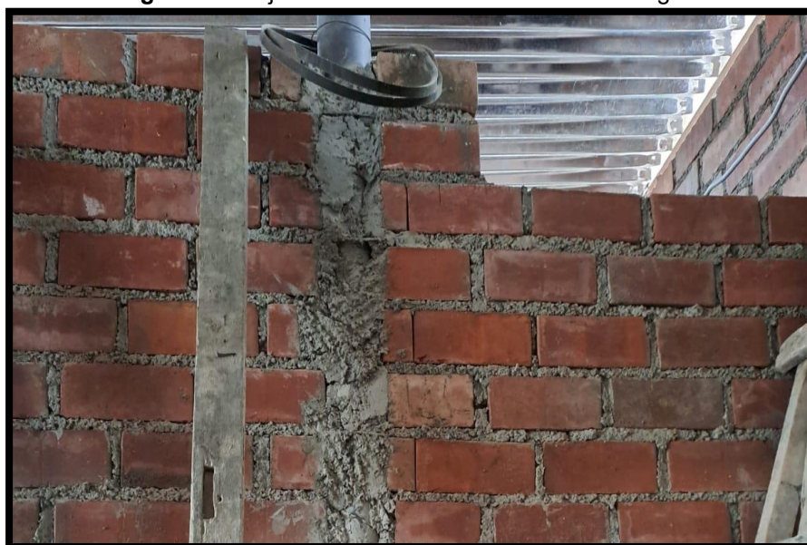
Figura 26. Bajantes de tubos de 4" afectando la viga.
