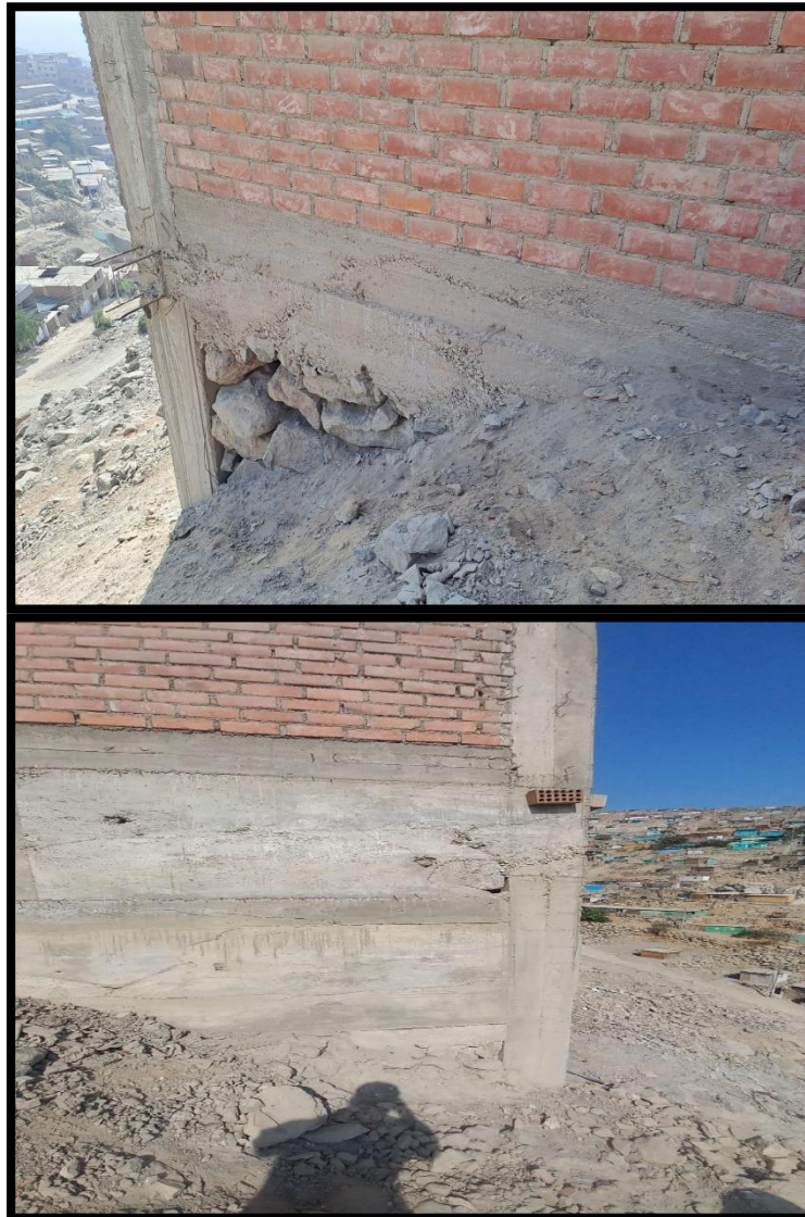
Figura 11. Cangrejeras en los elementos de concreto y la existencia de fisuras.
