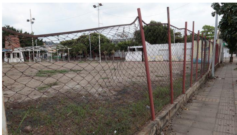
Figura 20: Deterioro de Parque Rojo y Negro, Cúcuta
