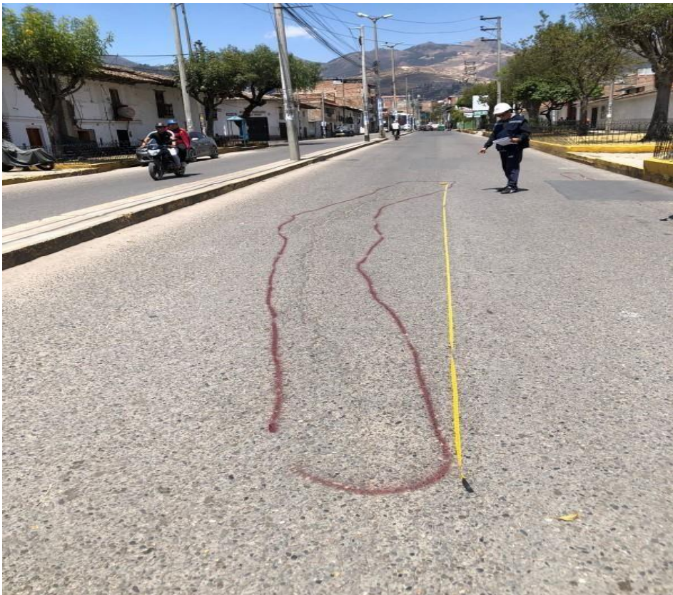
Señalización y medida de falla grieta longitudinal M-2
