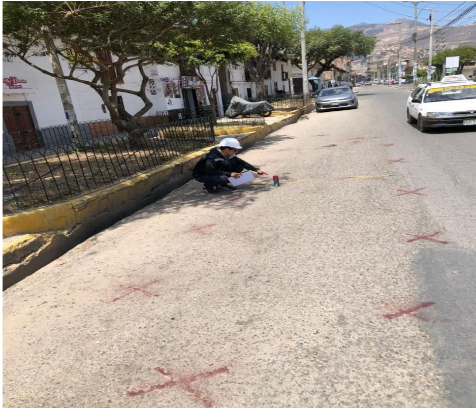
Medición de falla piel de cocodrillo (más predominante) M-2
