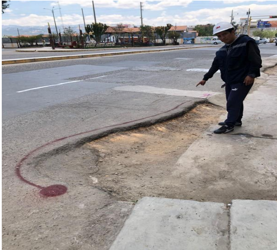
Grieta de borde hallada y señalada M-6
