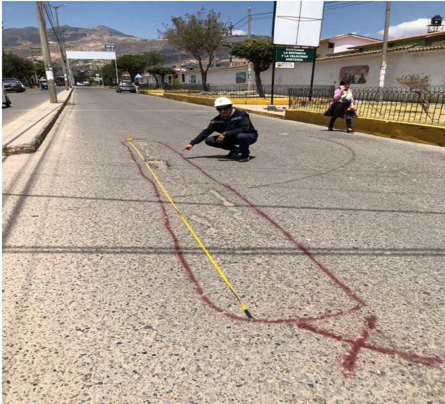
Se señala la amplitud de grietas longitudinales M-3
