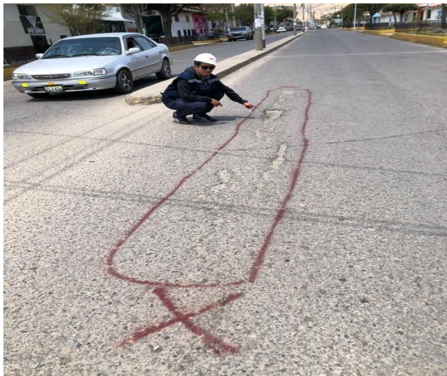
Indicación de la clase y severidad de fallas bacheos y grietas longitudinales M-3
