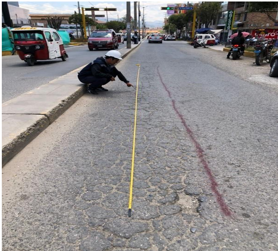
Se observa la extensión de la falla piel de cocodrilo M-4
