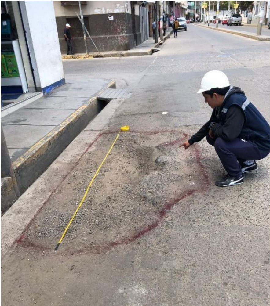
Se observa el tipo hueco y escala de falla superficial M-1
