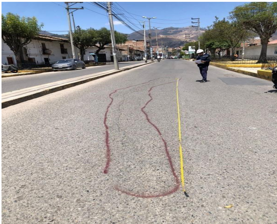
Falla superficial grietas longitudinales M-2
