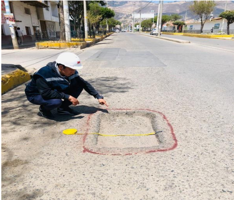
Se halla falla superficial de bacheo y parcheo M-3
