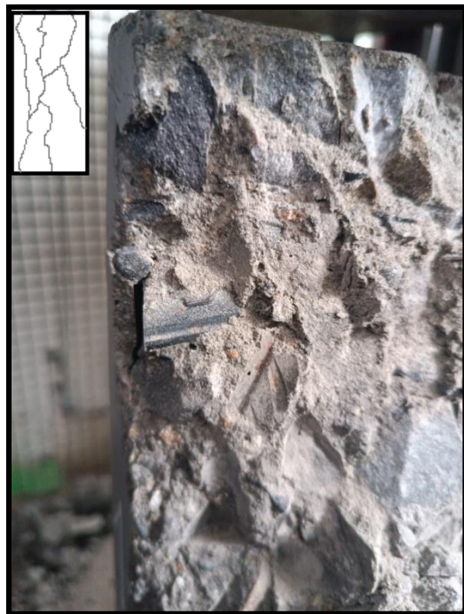
Grietas de acolumnado vertical a través de ambos extremos, ningún cono bien formado
