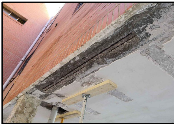
Figura 1. Deterioro de elementos estructurales.
