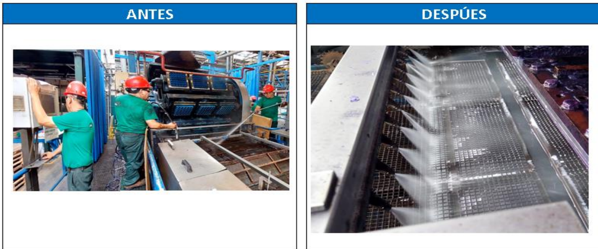
Figura 47. Lavar parrillas manualmente con hidro lavadora
