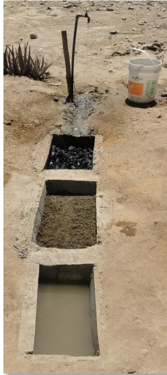
Figura 14. Vista general del biofiltro
