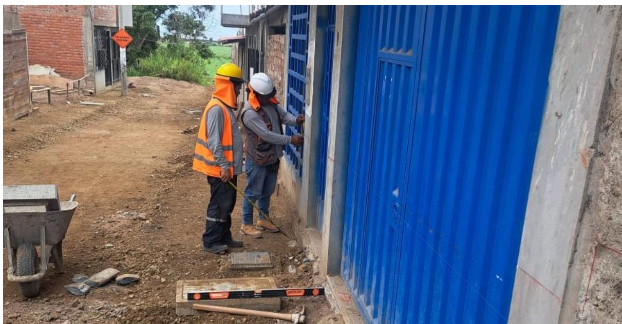
Figura 15. Intervención ante un mal uso de las herramientas de trabajo. Origen: galería fotográfica de la empresa
