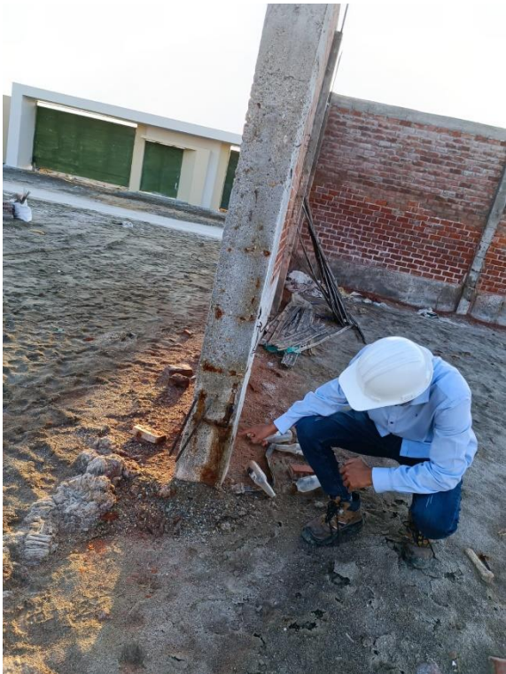
Figura 30: Cerco perimétrico afectado por drásticamente por la corrosión.
