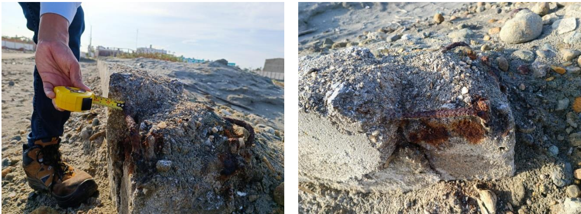
Figura 10: Perdidas de sección del concreto debido a la corrosión
