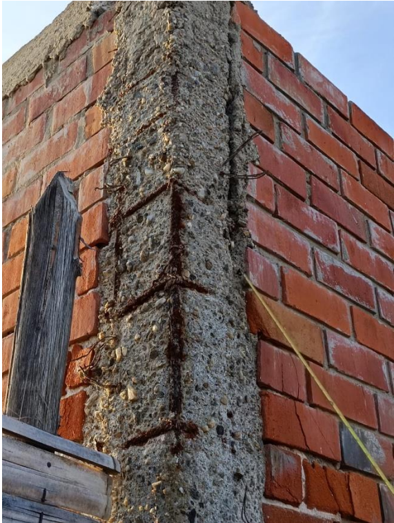
Figura 23: Perdidas de sección críticas en columnas
