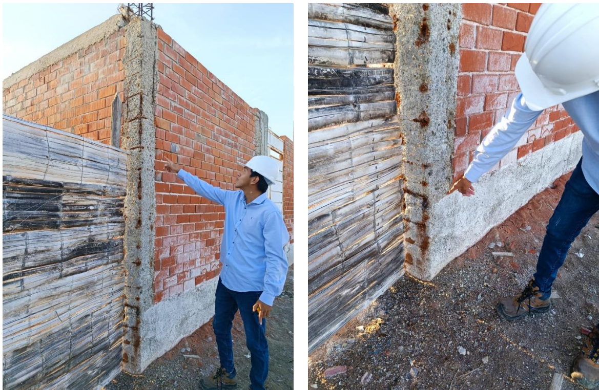
Figura 22: Nivel de corrosión crítica en columnas
