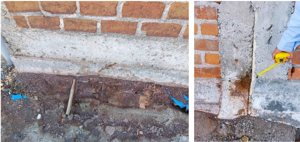
Figura 24: Estructuras abandonadas que pese a sus intentos por proteger a la estructura, fueron afectadas
