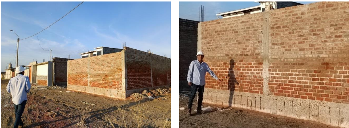
Figura 26: Humedad y salinidad afectando a la estructura, dejando niveles críticos de corrosión en sobrecimientos y columnas
