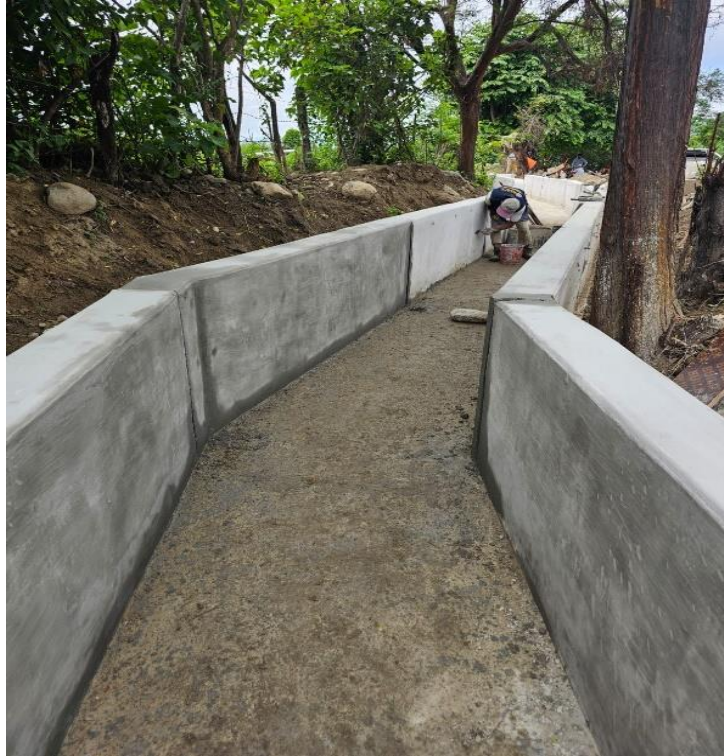
Figura 1: Reparación de bocatoma y canal de riego; en el sistema de riego Guayaquil en la localidad de bocanegra, Distrito de Morropón
