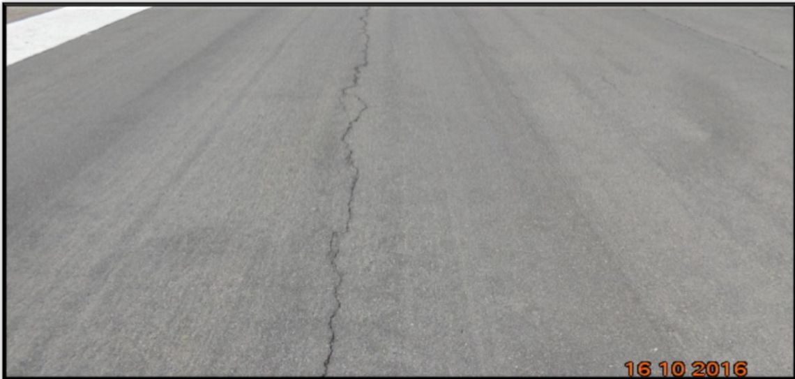
Fig. 8 Mediante la evaluación superficial (PCI), se encontró fisuras longitudinales en la Pista de Aterrizaje.
