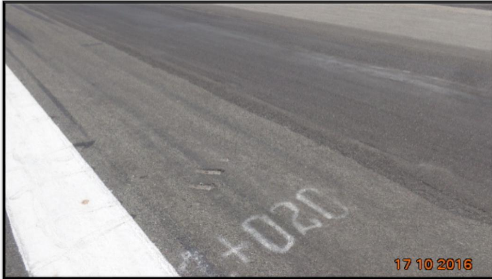
Fig. 10 Km 1+020 Se aprecia un tratamiento superficial a 2 metros del eje de la pista de aterrizaje en ambos lados.
