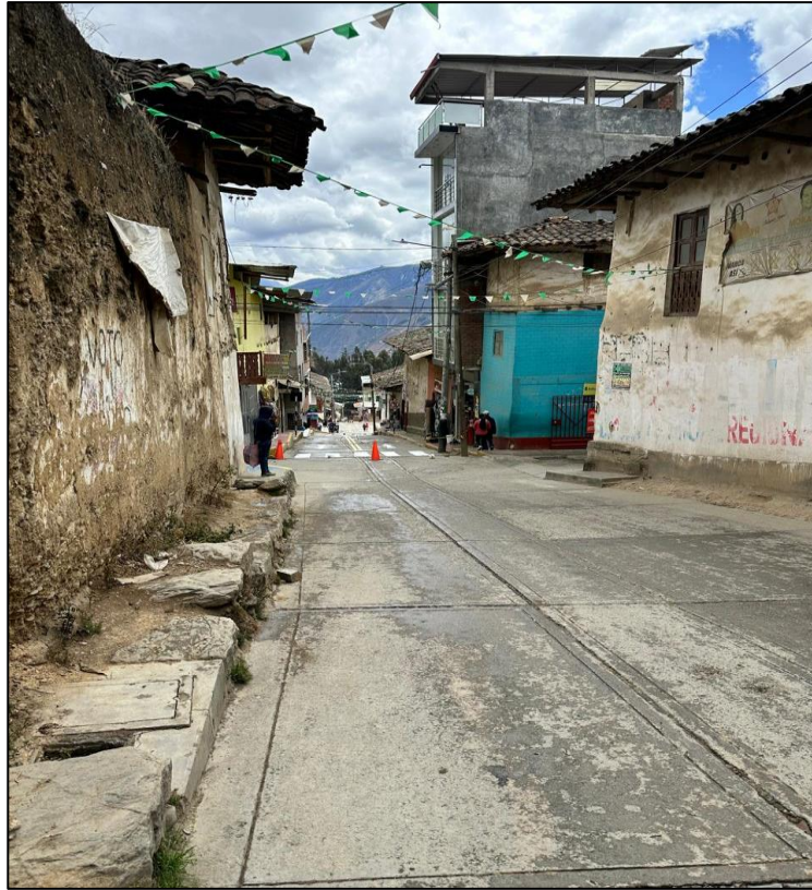
Fotografía 9: Vereda en mal estado del entono de la Plaza de Armas Av. San Martin.
