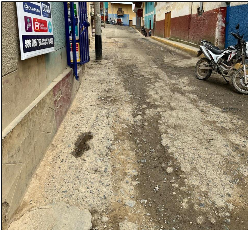
Fotografía 10: Vereda y vía en mal estado del entono de la Plaza de Armas Av. Salaverry.
