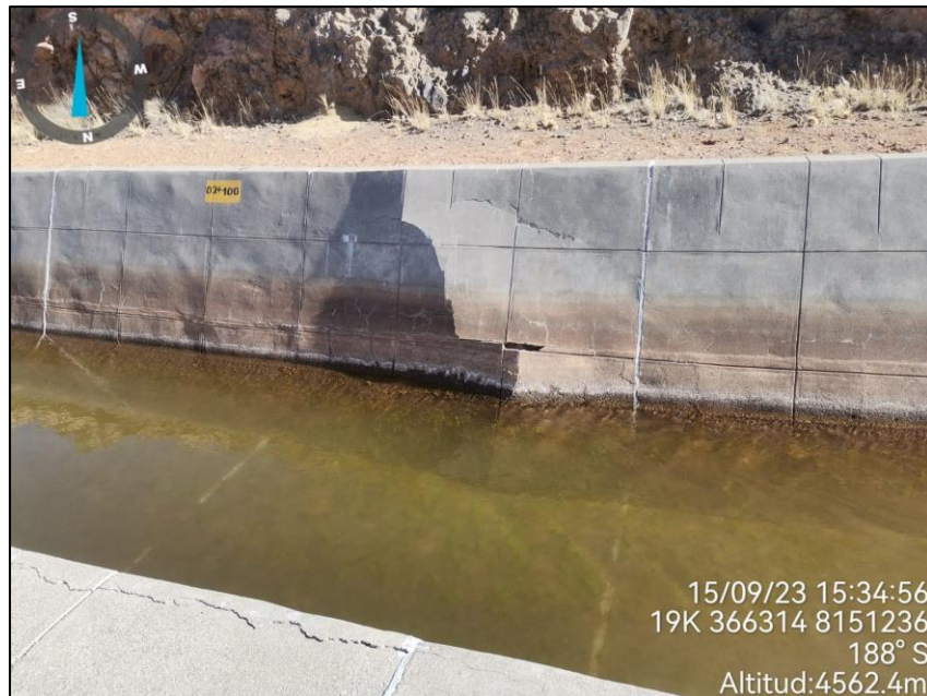
Fotografía 7. Descascaramiento del canal en la progresiva 03+100
