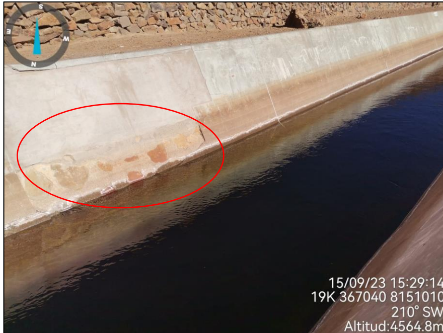
Fotografía 5. Desprendimiento de la impermeabilización del canal
