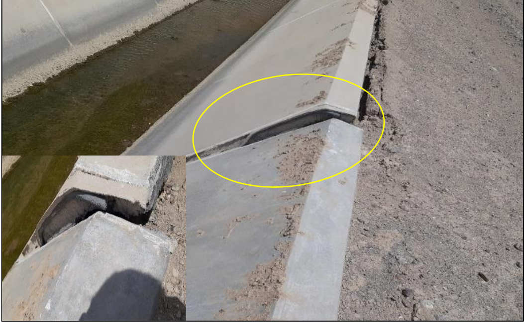
Fotografía 18. Desplazamiento del Canal por efectos de Sismos en la zona de Cerro Blanco
