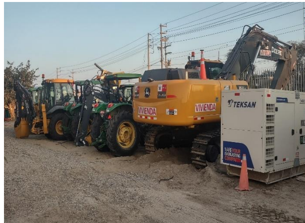
Figura 6 Área externa– Ubicación de la maquinaria
