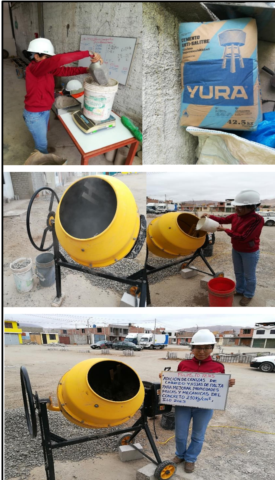
Fotografía 29. Mezcla C° patrón, primero se realizó el pesado del material según el diseño de mezcla, seguidamente se preparó la mezcla en un mezclador tipo trompo.
