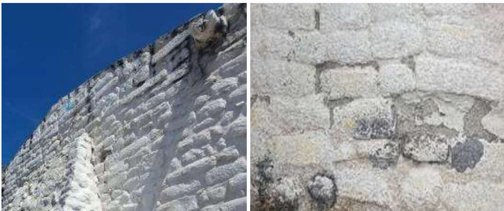
Figura 35. Pérdida sistemática de mortero de muros
