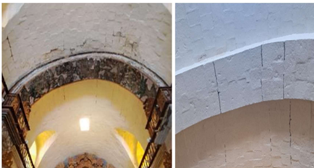
Figura 36. Deformación y deterioro del diafragma
