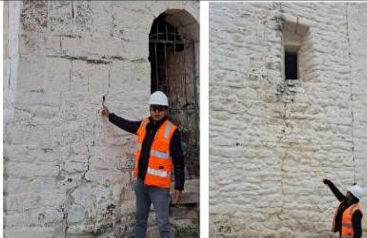
Figura: Irregularidad de bloques de muros de la Torre principal así mismo fisuramiento de la misma.
