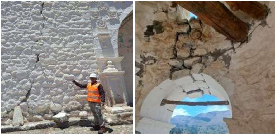
Figura 12. Inspección de las patologías de la Iglesia Santa Ana
