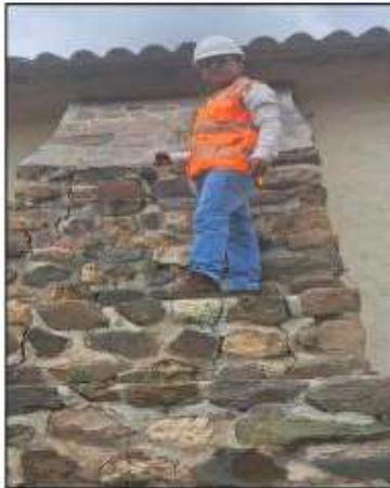
Figura: Contrafuertes que no cuentan con uniformidad.
