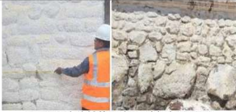
Figura: Irregularidad de bloques de muros de la iglesia Santa Ana
