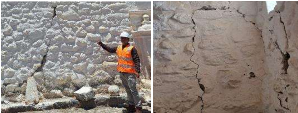
Figura 39. Muros resistentes con grietas producto del sismo
