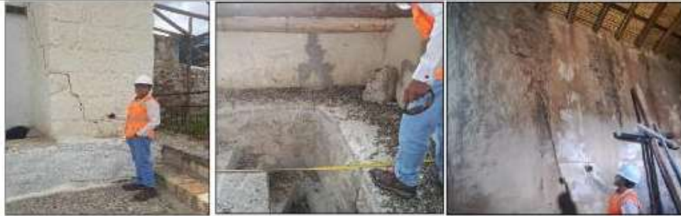
Figura: Irregularidad de bloques de muros
