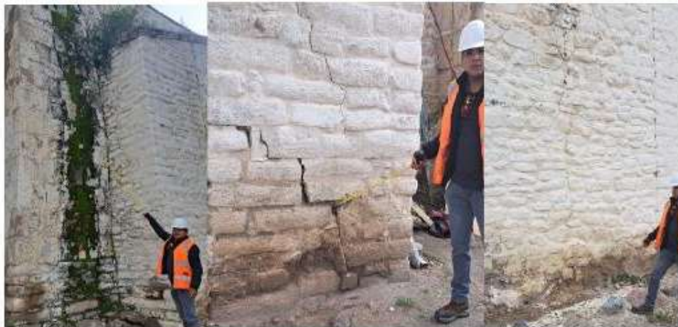
Figura: Muros con grietas, deterioro de materiales e infiltración de agua
