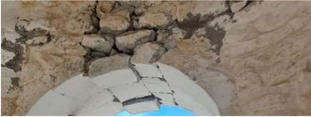
Figura 40. Deterioro de muros
