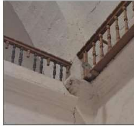
Figura: Conexión deficiente entre elementos verticales
