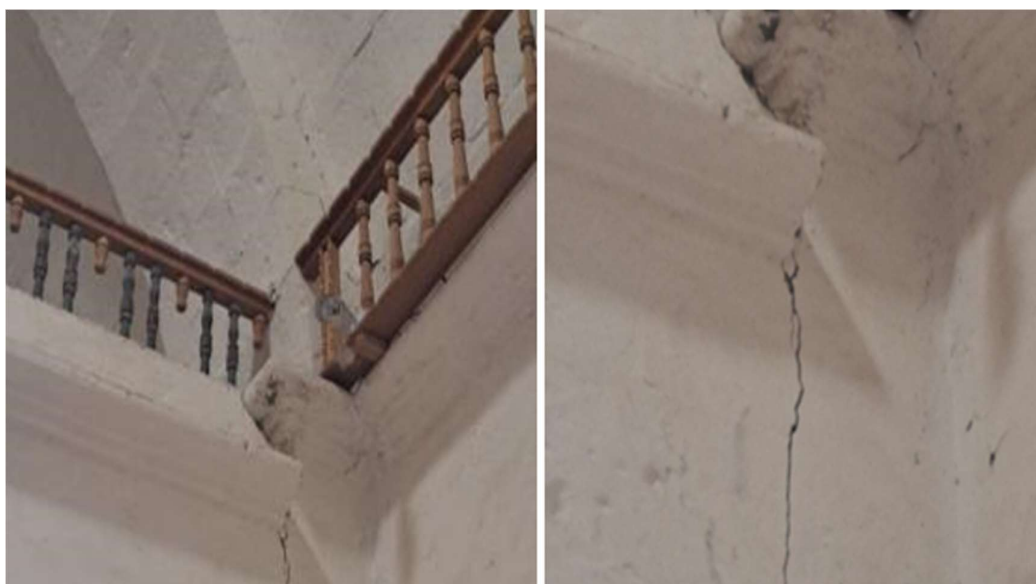
Figura 37. Conexión deficiente entre elementos horizontales
