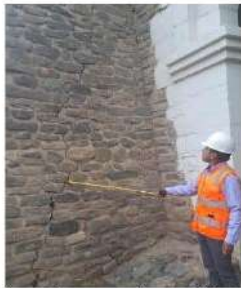
Figura: Muros con mal puestas diferentes
