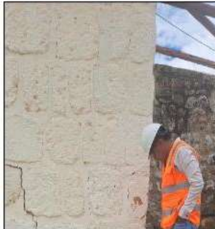
Figura: Deficiente conexión entre muros
