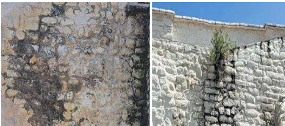
Figura 41. Infiltración de agua y ataque biológico en muros de la iglesia
