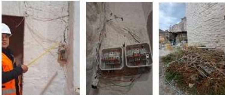
Figura: Materiales inflamables, instalaciones eléctricas deficientes y basura en el recinto.
