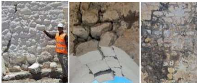
Figura: Muros con grietas, deterioro de materiales e infiltración de agua
