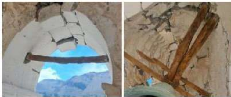
Figura: Refuerzo con materiales incompatibles
