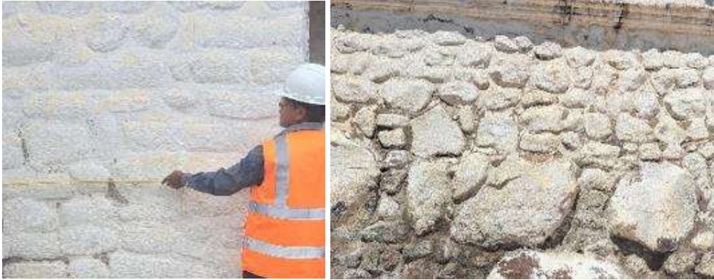
Figura 34. Irregularidad de bloque en muros
