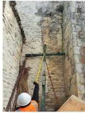
Figura: Deficiente conexión entre muros
