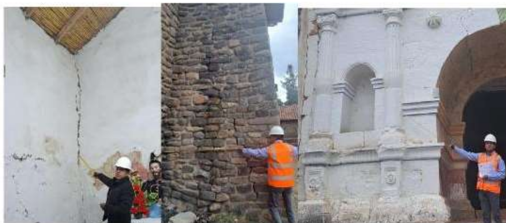
Figura: Muros con grietas, deterioro de materiales e infiltración de agua
