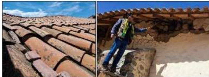
Figura: Deformación en cubierta de teja Andina.
