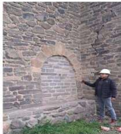
Figura: Deficiente conexión entre muros
