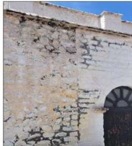
Figura: Deficiente conexión entre muros
