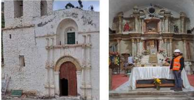
Figura: Elementos no estructurales de la iglesia tanto en la parte frontal y ornamento principal.
