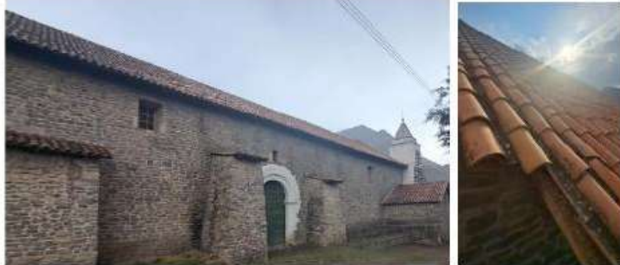
Figura: Deformación en cubierta de teja Andina.
