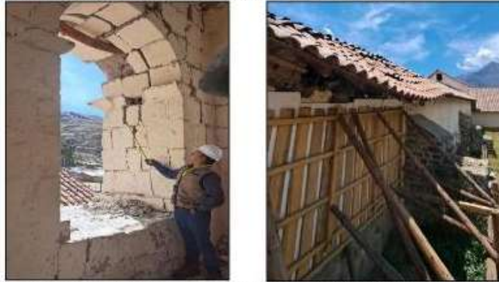
Figura: Refuerzo con materiales incompatibles y no evidencia resistencia y rigidez
