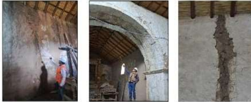
Figura: Muros con grietas, deterioro de materiales e infiltración de agua.
