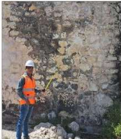
Figura: Muros con mal puestos diferentes
