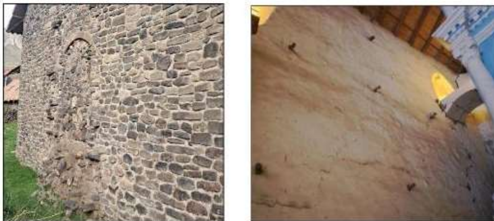
Figura: La Parte lateral compuesta por material incompatible que no promueve una adherencia eficiente y puede dar resultado a fallos en la estructura.
