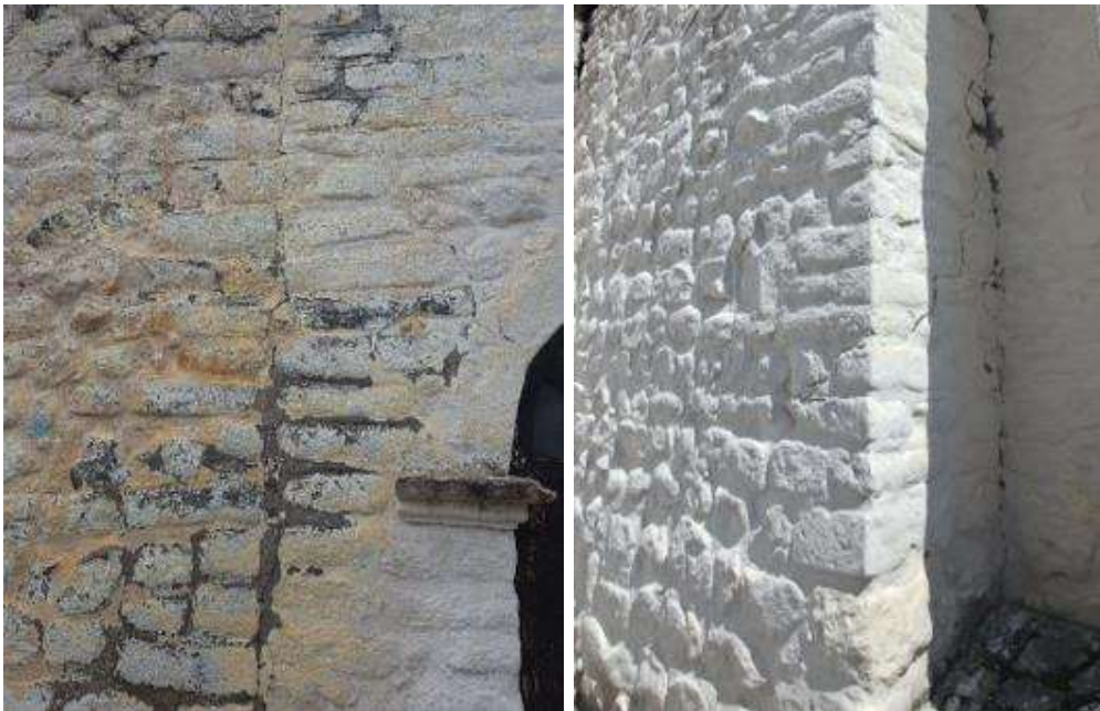
Figura 32. Deficiente conexión entre muros
