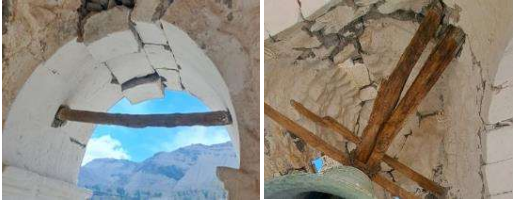
Figura 43. Refuerzo con materiales no compatibles
