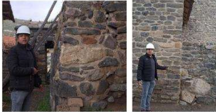
Figura: Irregularidad de bloques en contrafuerte y parte frontal del monumento.
