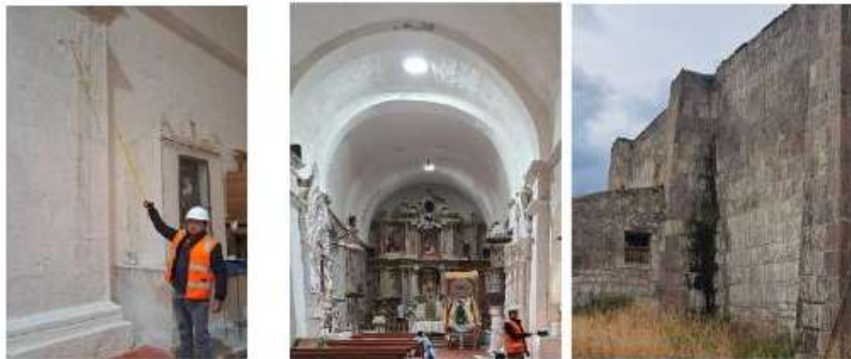
Figura: Deformación del diafragma, Conexión deficiente entre elementos verticales.
