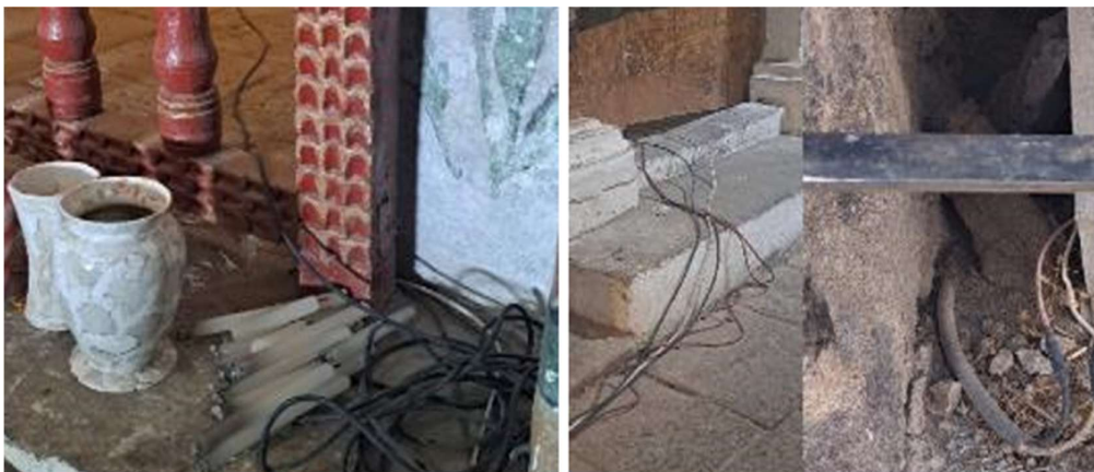
Figura 45. Instalaciones eléctricas inadecuadas
