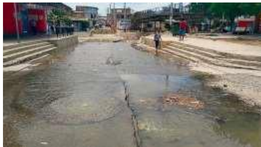
Figura 49. Aguas servidas permanentes.
