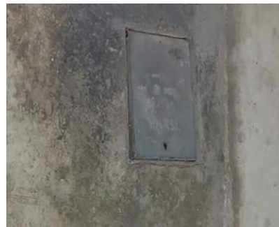
Foto N°4: Buzones en Rio Huancabamba
