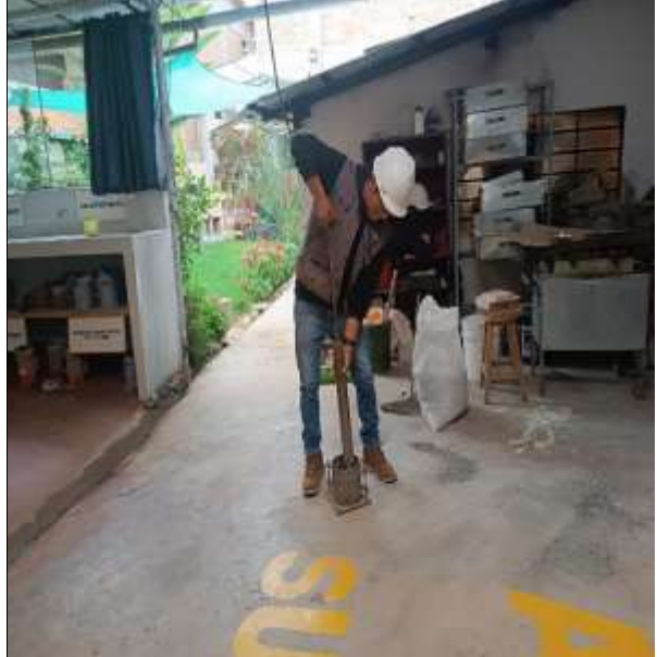
después de tamizar por la malla de \frac{3}{4} " r, se compacta, por capas con esfuerzo de golpes.
