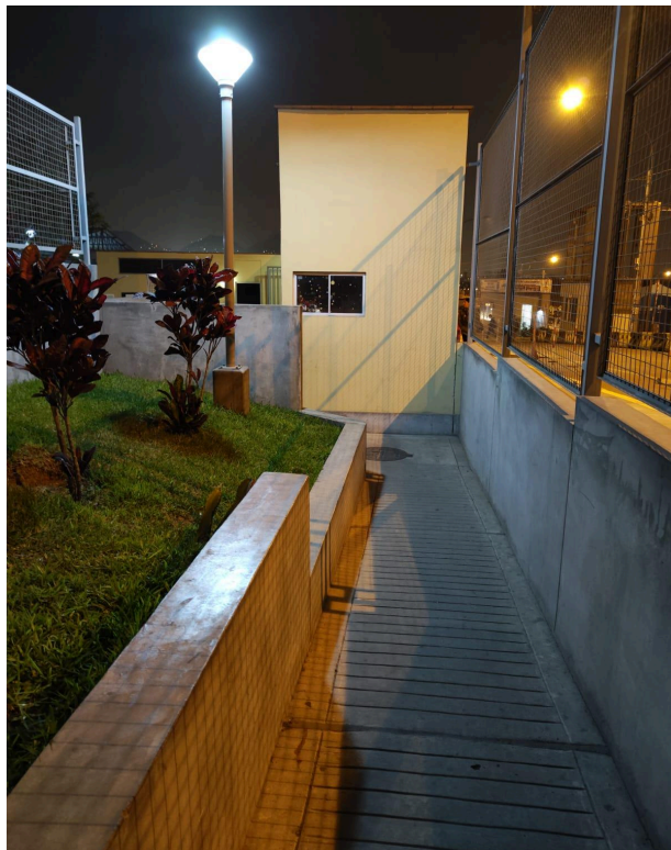
FIGURA 6: Evidencia de vías peatonales estrechas sin barandas de seguridad.
