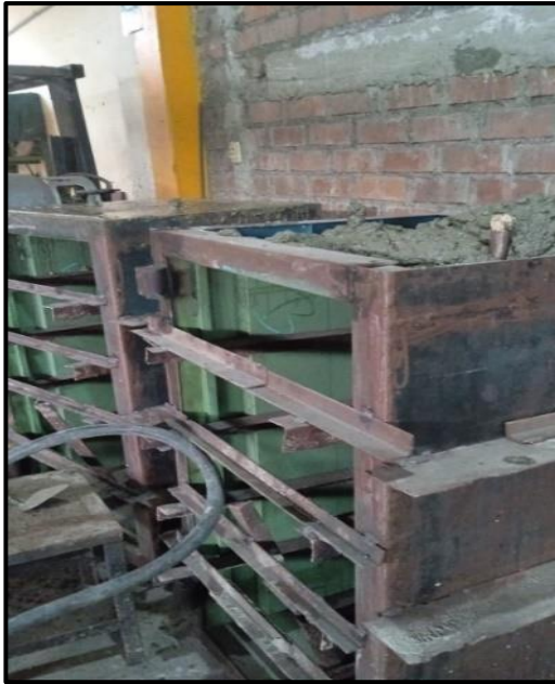
Figura 10. Caja con refuerzos exteriores (Antes)
