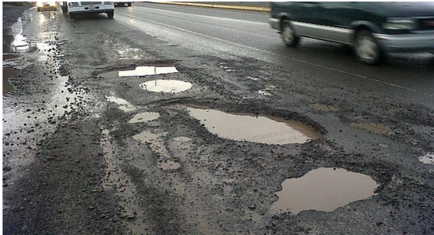
Imagen 1.15. Presencia de baches en las vías
