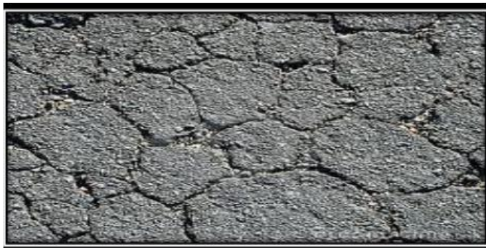
Imagen 1.19. Falla piel de cocodrilo
