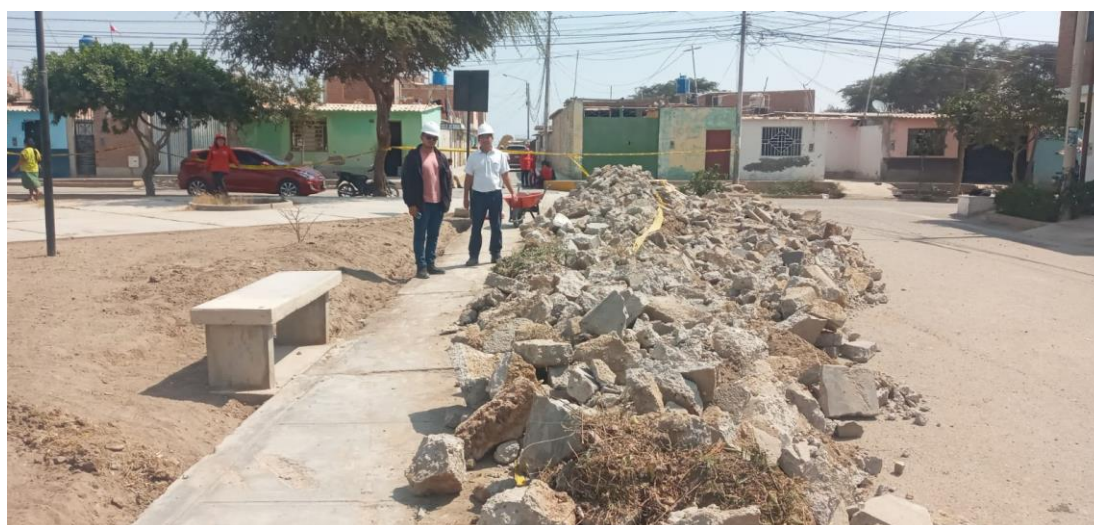
Foto 4.-Se aprecia materiales de construcción producto de demoliciones de veredas en Lambayeque.
