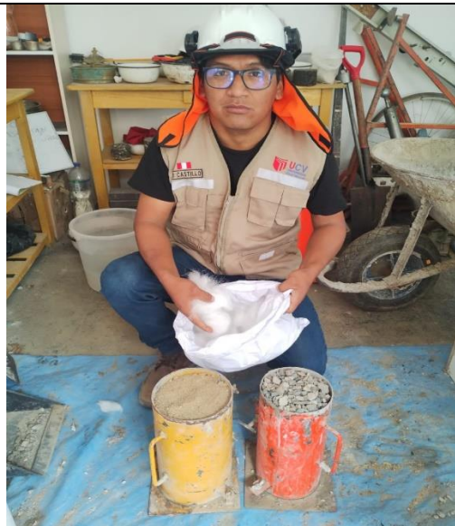
Dosificación para mezcla
