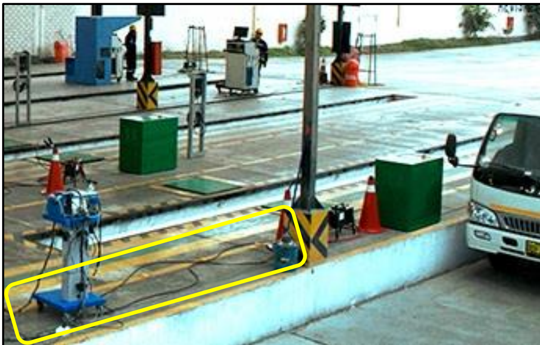
Gráfico N° 8: Cables de opacímetro expuesto
