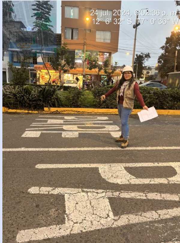
IMAGEN 01 - PATOLOGIA DE PIEL DE COCODRILO - CUADRA 02 - MUESTRA 02 - LADO IZQUIERDO
