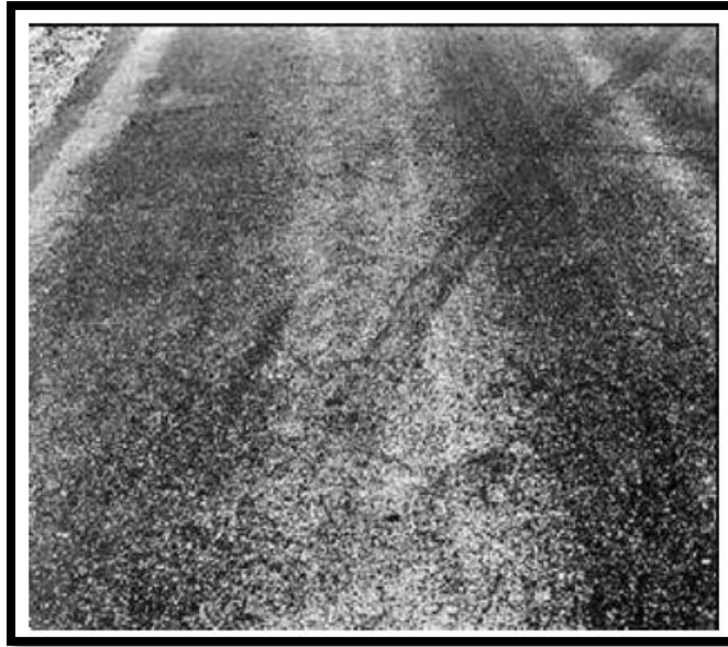
Figura 02: Patología Exudación – Fuente: Norma ASTM D6433.
