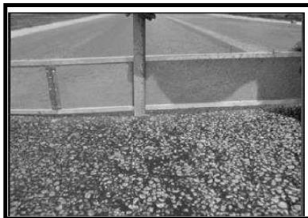
Figura 15: Patología Ahuellamiento– Fuente: Norma ASTM D6433.
