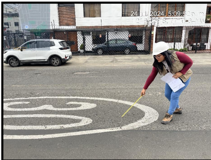
Figura 10: Patología Grietas longitudinales y transversales– Elaboración propia.
