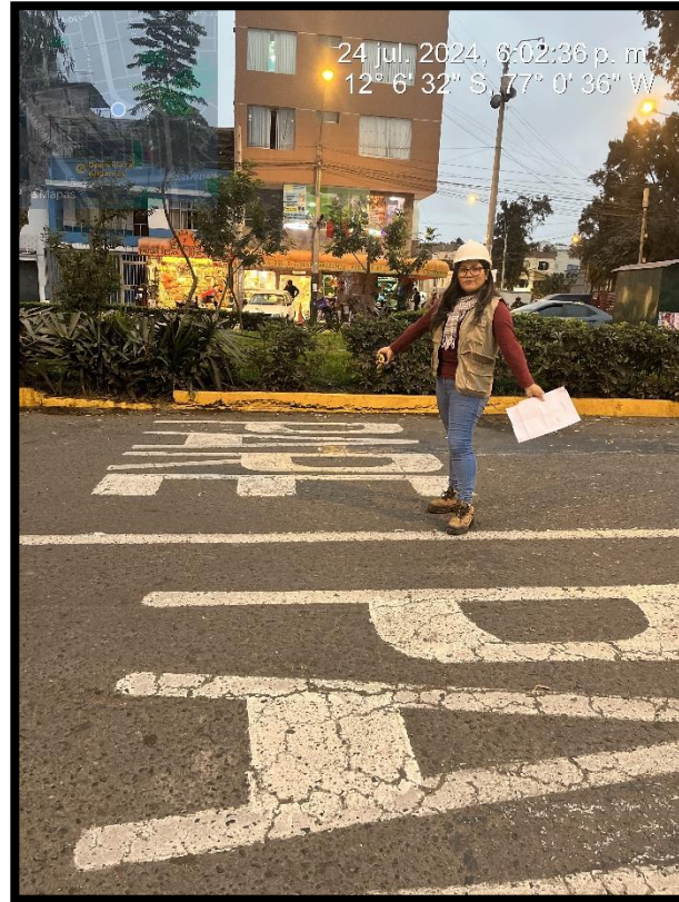
Figura 01: Patología Piel de Cocodrilo – Elaboración propia.
