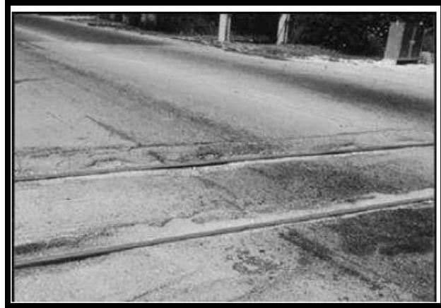
Figura 14: Patología Cruce de vía férrea– Fuente: Norma ASTM D6433.
