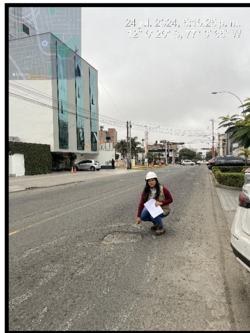
Figura 13: Patología Huecos– Elaboración propia.
