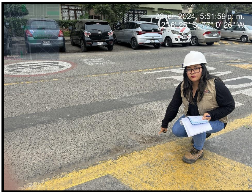
Figura 07: Patología Grieta de borde– Elaboración propia.
