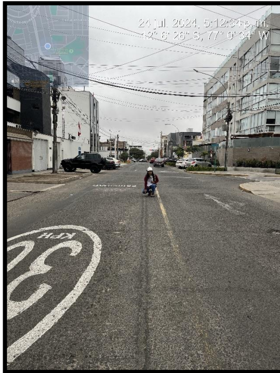
Figura 08: Patología Grieta o reflexión de junta– Elaboración propia.
