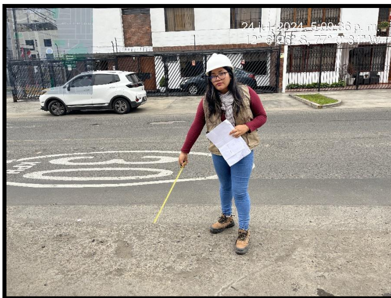
Figura 19: Patología Desprendimiento de agregados– Elaboración propia.
