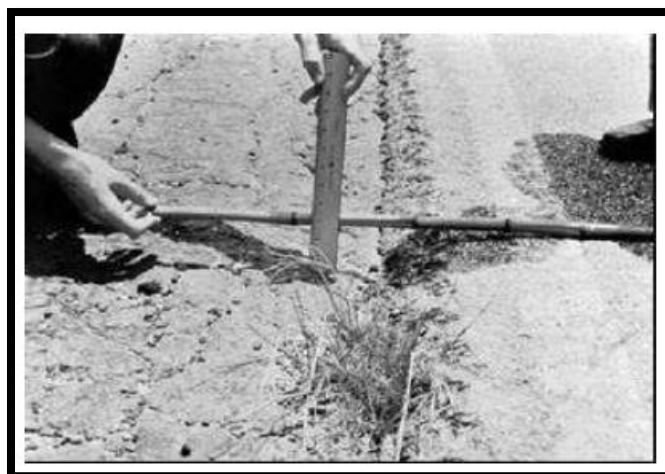
Figura 09: Patología Desnivel de carril – Fuente: Norma ASTM D6433.
