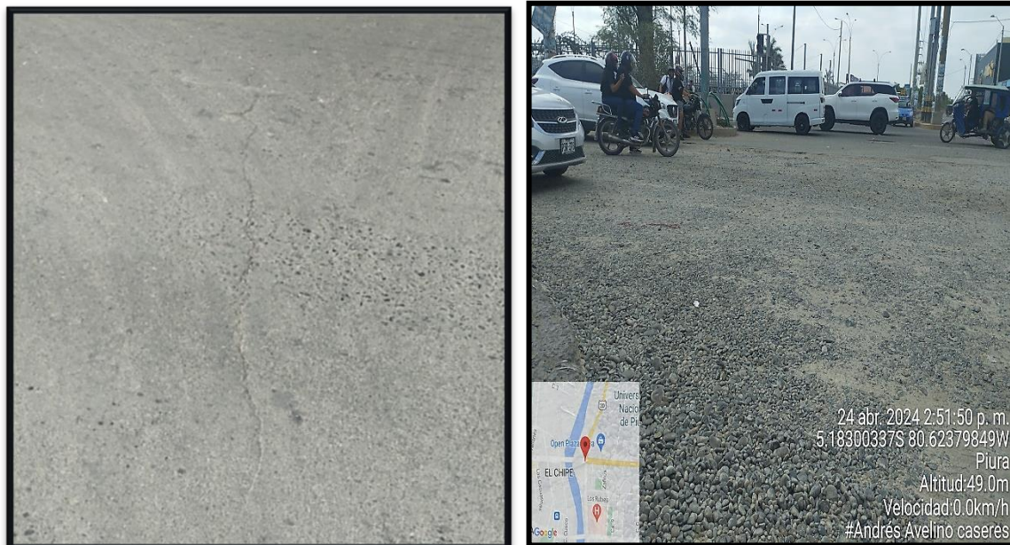
Figura 2: localización de fallas asfálticas en la Av. Andrés Avelino Cáceres
