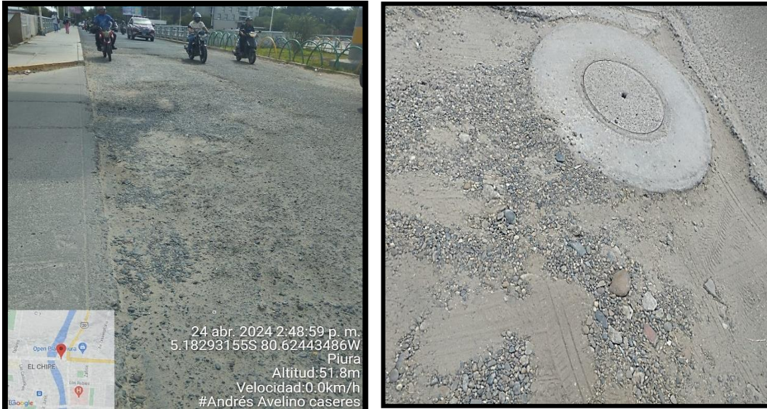
Figura 01: Desprendimiento de Agregados de la Avenida en estudio
