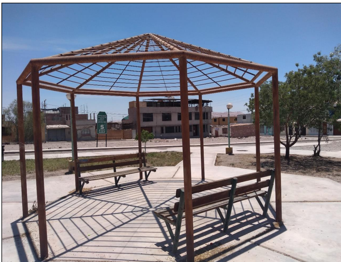
Figura 23. Cobertura deterioradas y expuestas al medio ambiente
