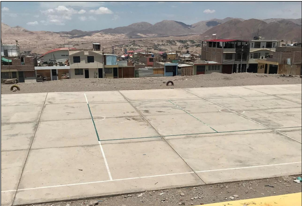
Figura 15. Capacidad estructural limitada
