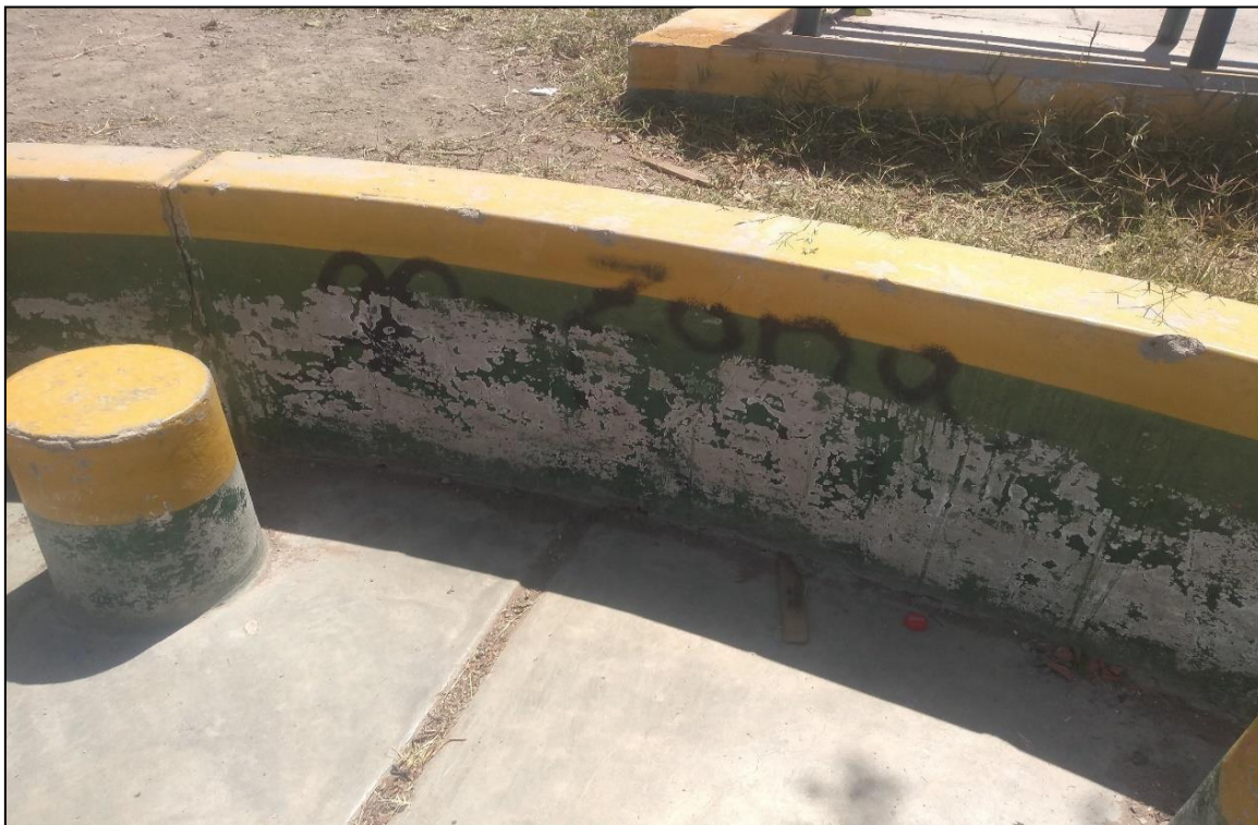
Figura 26. Deterioro estructural de cemento
