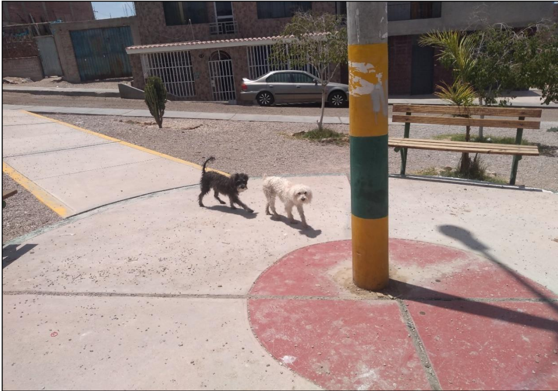
Figura 27. Senderos peatonales agrietados
