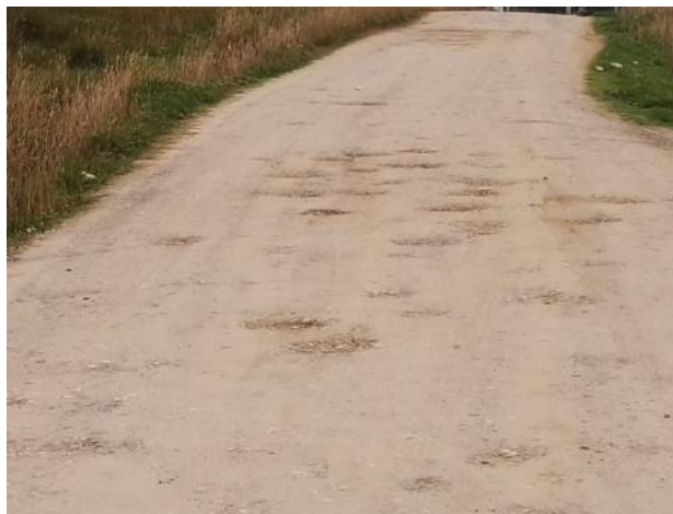
Figura 39. Caminos de tierra deteriorado por desmorte.
