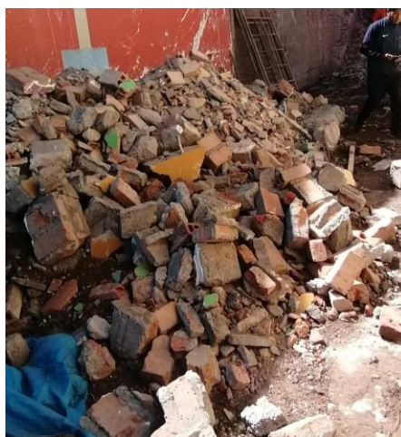
Figura 4. Residuos de muros de albañilería
