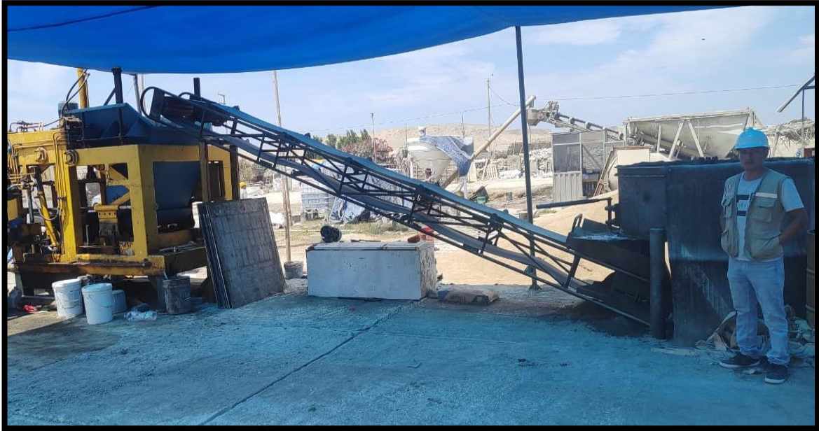
Foto N° 13: Se muestra la máquina de fabricación de adoquines desde la mezcladora, la faja de distribución y la máquina de fabricación a vibrado y compresión de adoquinó.
