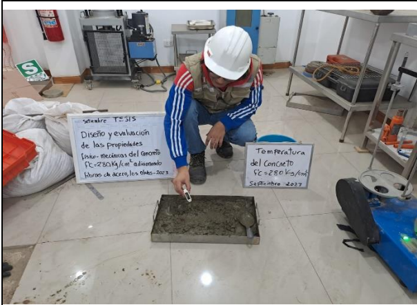
FECHA DE LA FOTOGRAFÍA 14 DE SET DEL 2023 Evidencia Fotográfica N° 19 Control de la temperatura del concreto
