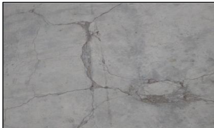
Figura 5. Fallas en la losa de concreto
