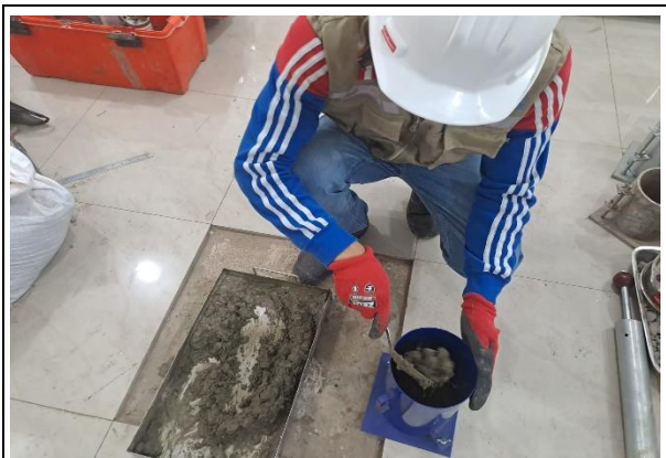
FECHA DE LA FOTOGRAFÍA 14 DE SET DEL 2023 Evidencia Fotográfica N° 21 Moldeado de las probetas cilíndricas
