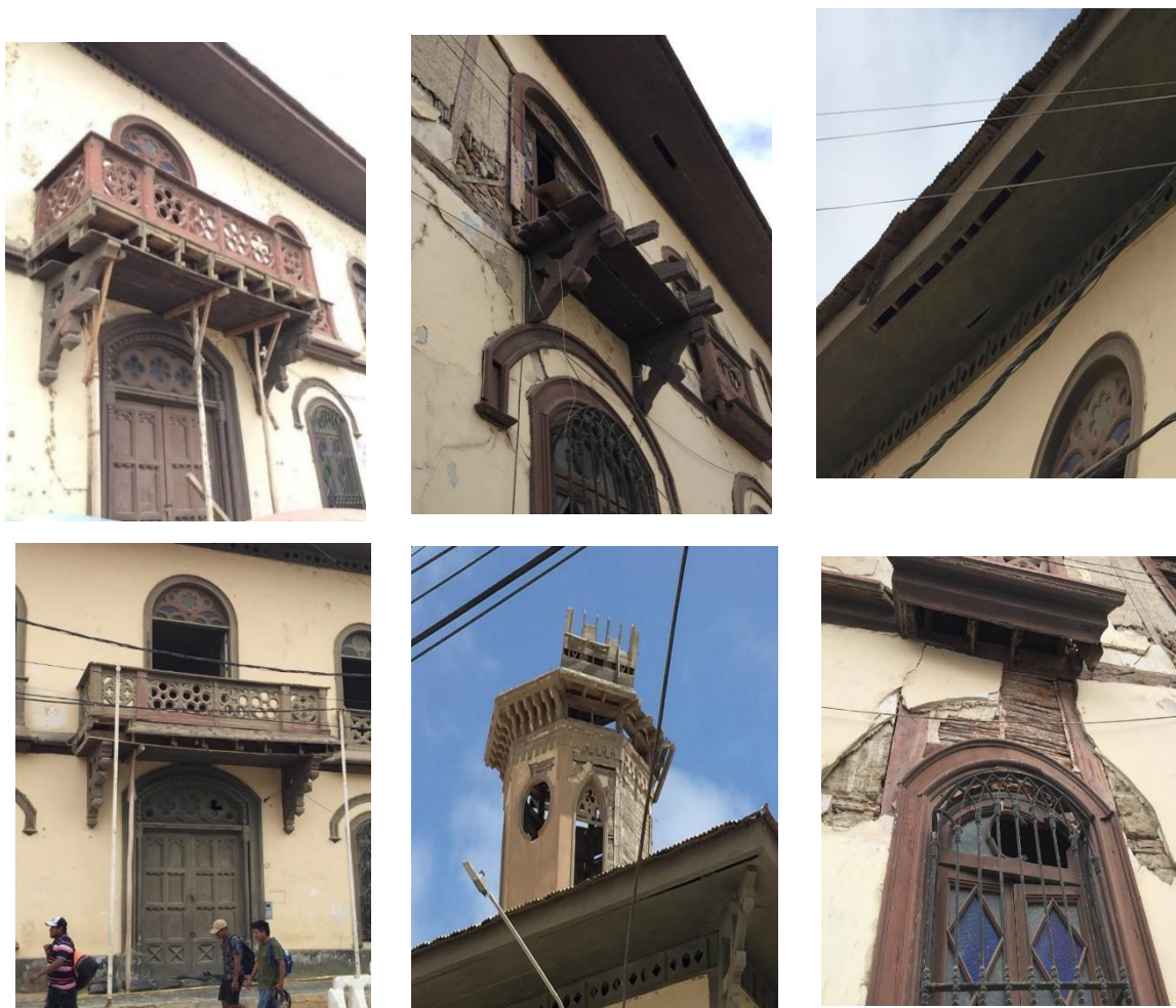
FIGURA 6. Nivel de conservación de la fachada del inmueble la ex aduana de Paíta en balcones y revestimiento.
