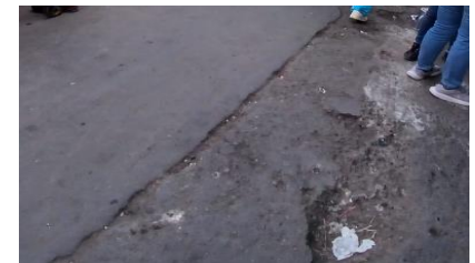
La pista se encuentra en mal estado ya que el asfalto esta deteriorado
