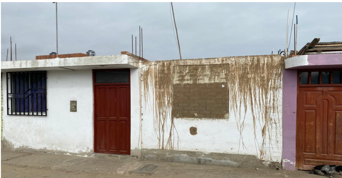
Figura N°6: Presencia de salitre en paredes
