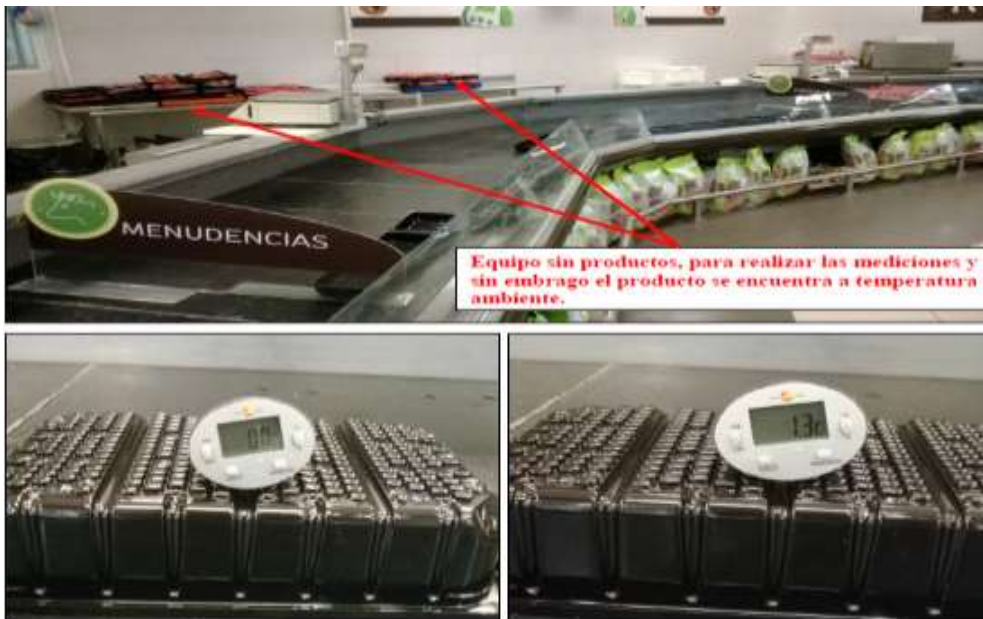
Figura 14: Productos fuera de área de conservación
