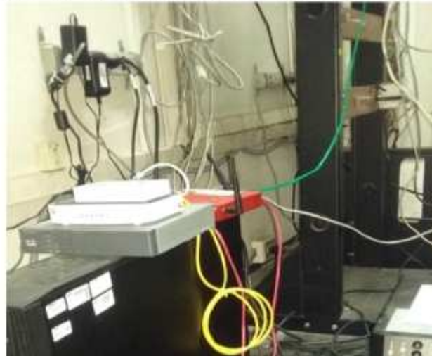
Figura N° 8, Desorden del cableado de red Cat.5
