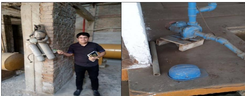
Figura 32. Mal uso de los equipos de protección personal
