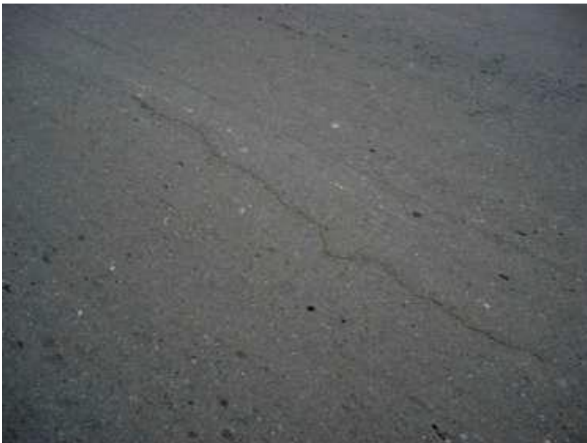
Figura 15. Fisuras longitudinales y transversales
