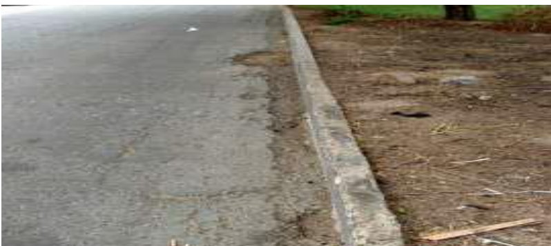
Figura 14. Fisuras de borde. Se aprecia que la grieta de borde que ha dañado severamente el borde de la vía.
