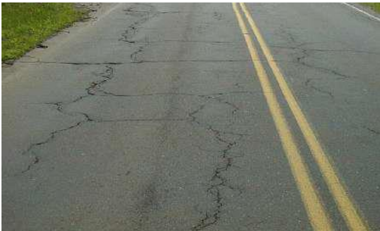
Figura 10. Fisuras en bloque
