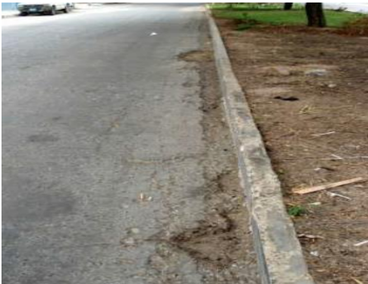
Figura 6. Fisura de borde, un tipo de falla muy común en zonas cerca de parques y bermas centrales
