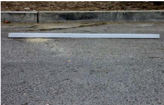
Figura 11. Abultamientos y hundimientos, se señala el desplazamiento hacia arriba de la superficie del pavimento
