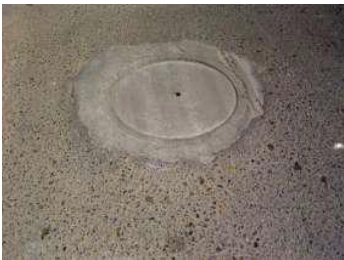
Figura 17. Parche de cortes utilitarios
