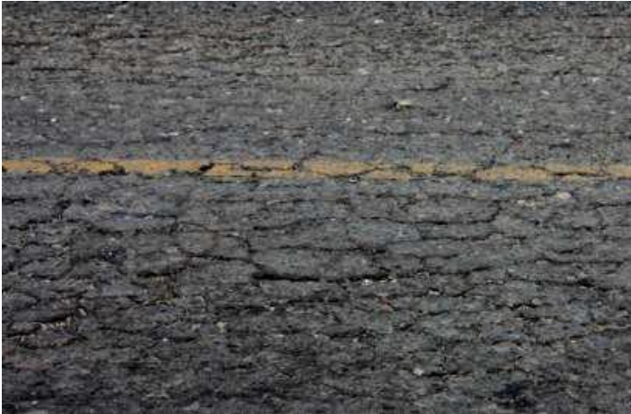
Figura 8. Piel de Cocodrilo, falla tipo piel de cocodrilo: las fisuras se conectan unas con otras formando polígonos irregulares.
