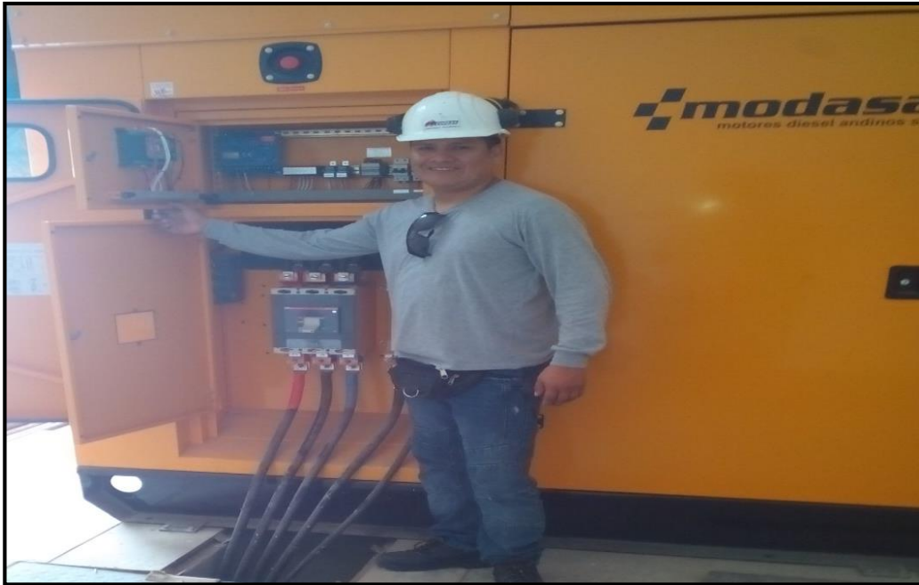
Observando los datos del grupo electrógeno.
