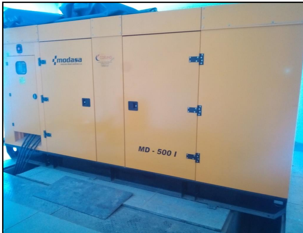
Grupo electrógeno del hospital regional de Jaén.
