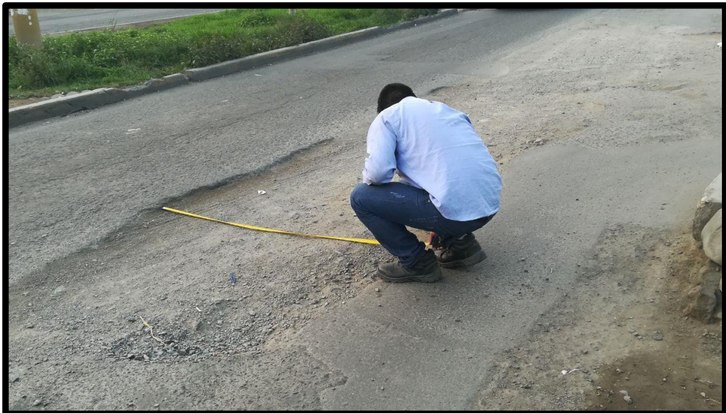
Foto N° 02: Medición de las fallas del pavimento.
