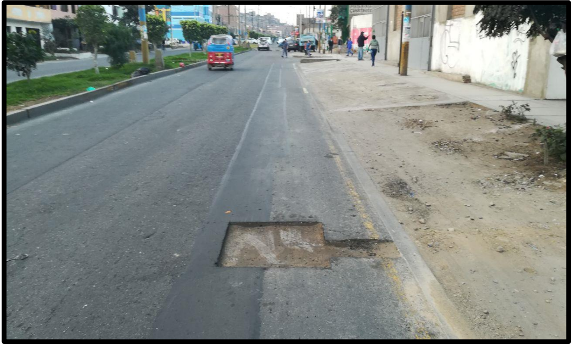
Foto N° 03: Tipo de falla Parches en la Av. República de Polonia
