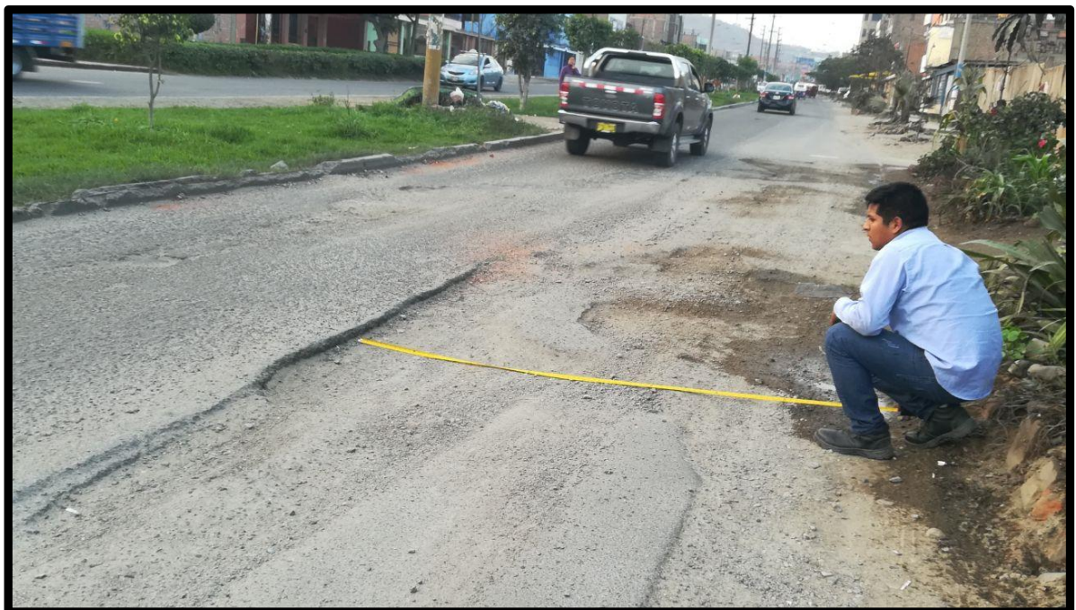
Foto N° 06: Tipo de falla Desprendimiento en la Av. República de Polonia
