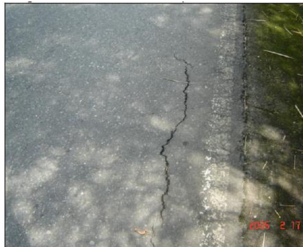
Figura 13: Grieta de borde
