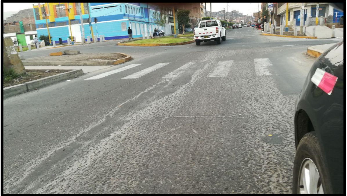
Foto N° 05: Tipo de falla Piel de Cocodrilo en la Av. República de Polonia
