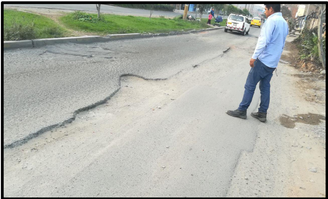
Foto N° 04: Tipo de falla Grieta de Borde en la Av. República de Polonia
