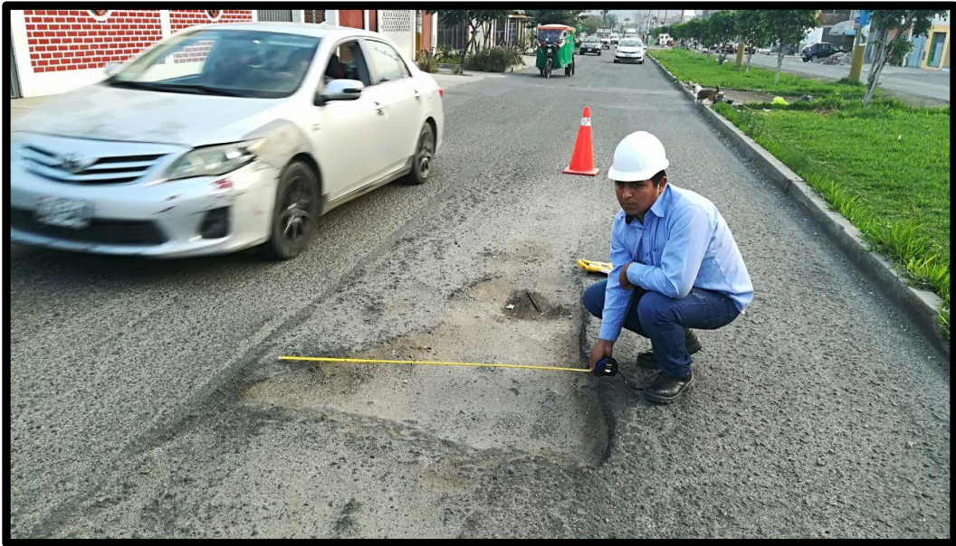
Foto N° 01: Tipo de falla Huecos en la Av. República de Polonia.
