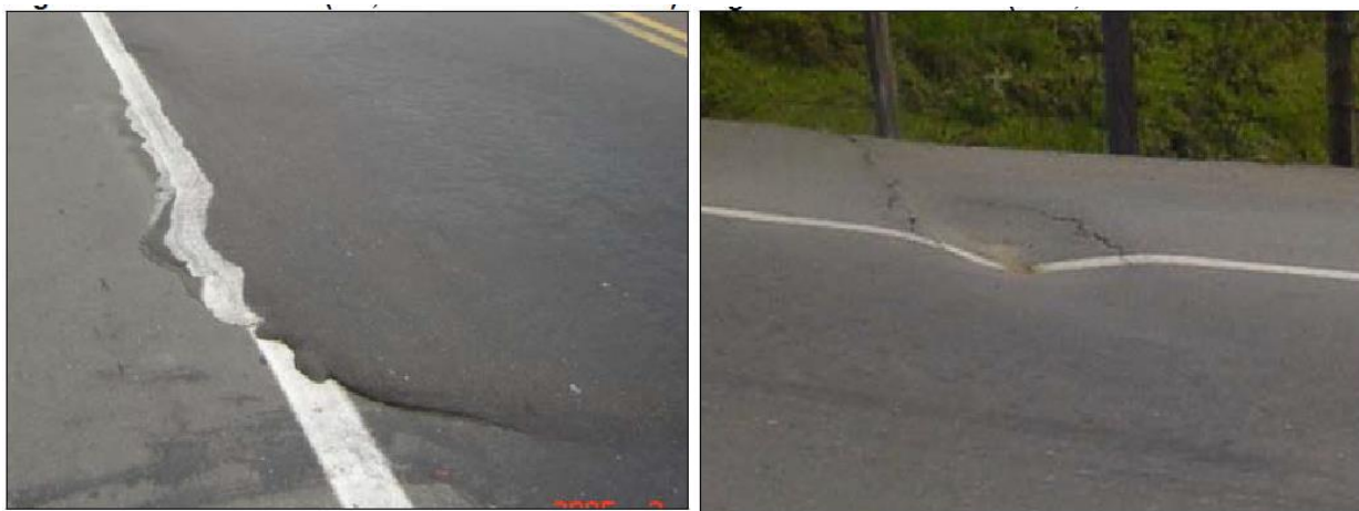
Figura 10: Abultamiento y hundimiento
