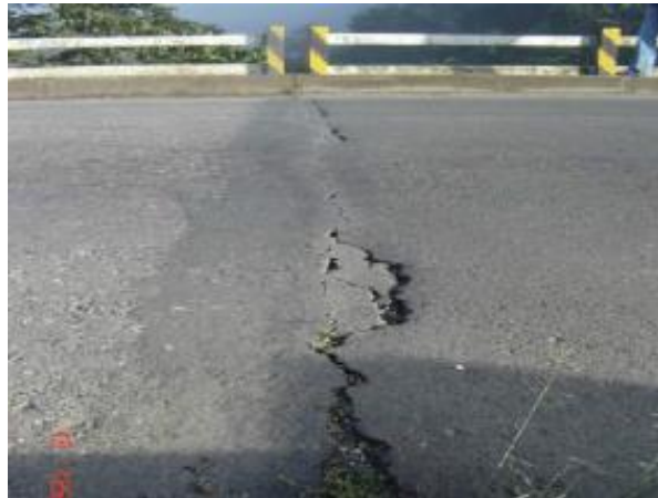
Figura 14: Grieta de reflexión de junta
