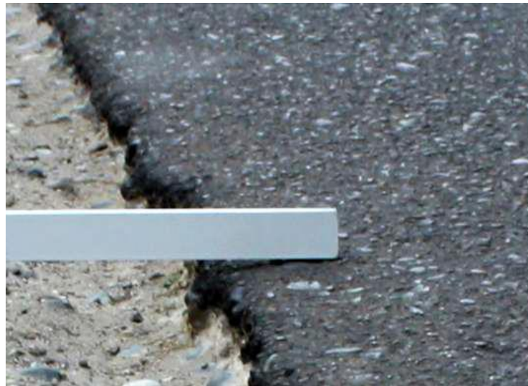
Figura 15: Desnivel de carril / berma
