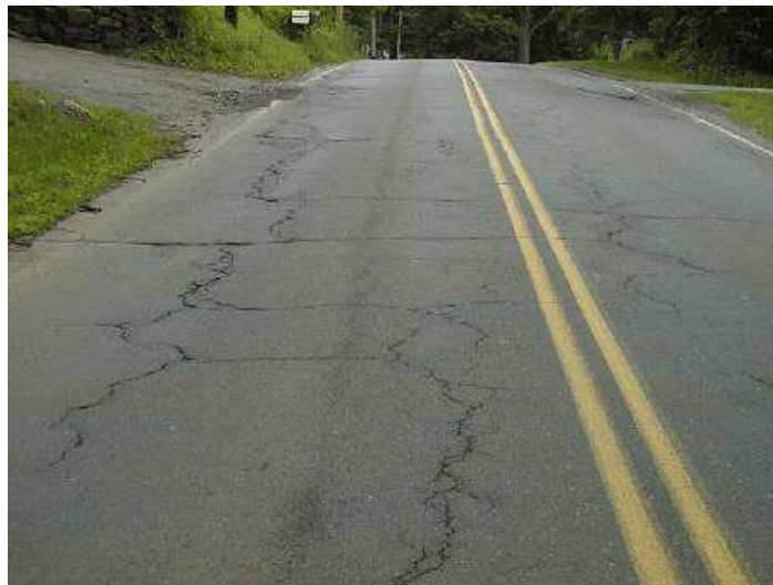
Figura 9: Agrietamiento en bloque
