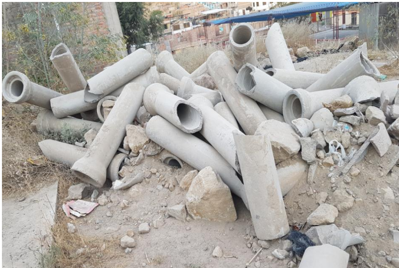
Figura 1.2. Colapso de Tuberías de Agua Potable.
