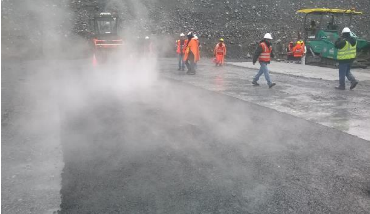
Fotografía 16: Cancha de prueba interna, capa compactada, el contenido de asfalto usado fue de 7%.
