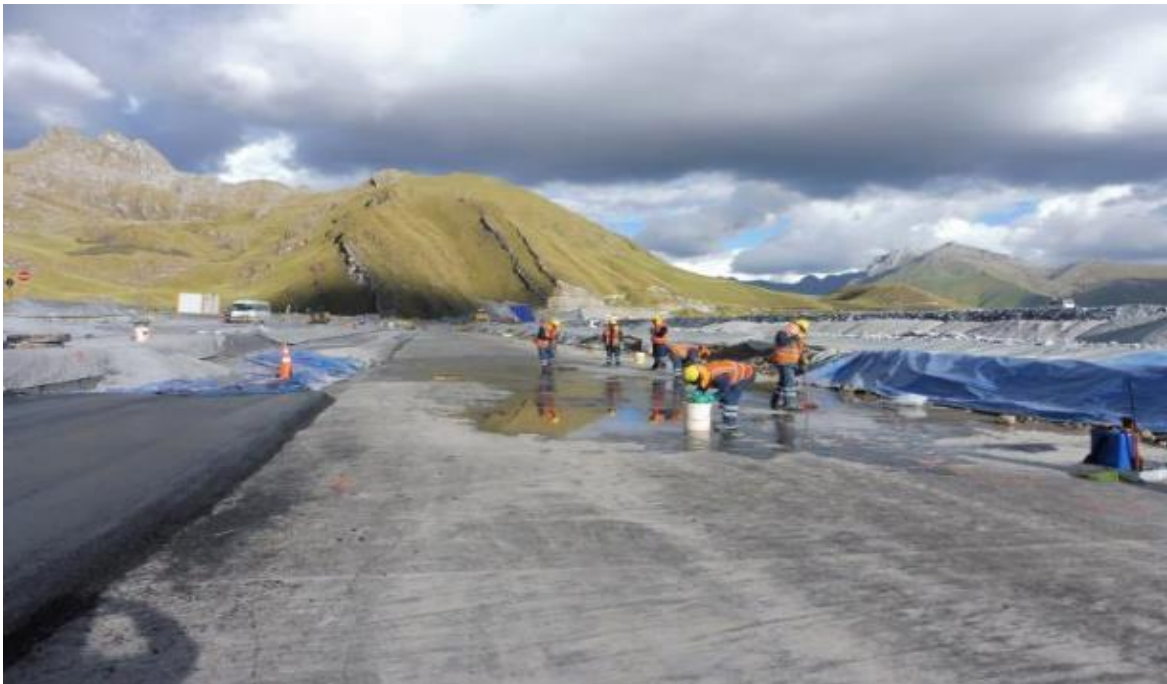
Fotografía 17: Limpieza de la superficie de la geomembrana bituminosa para inspección entre las progresivas 0+520 km hasta la 0+605 km y posterior colocación de concreto asfáltico.
