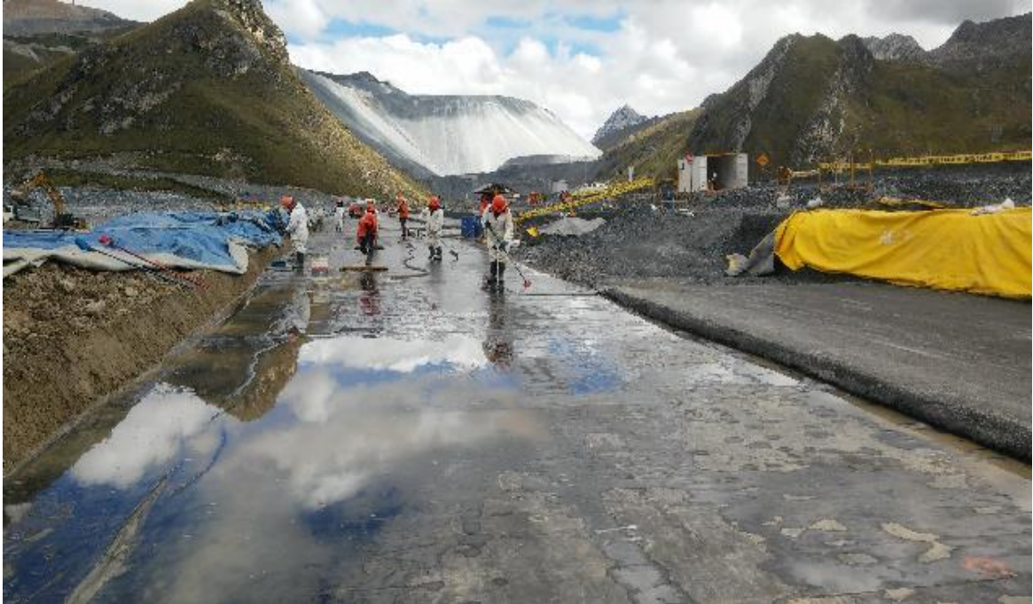
Fotografía 18: Limpieza y eliminación del agua sobre la geomembrana bituminosa, para inspección de la geomembrana bituminosa y su posterior colocación del Mastic.
