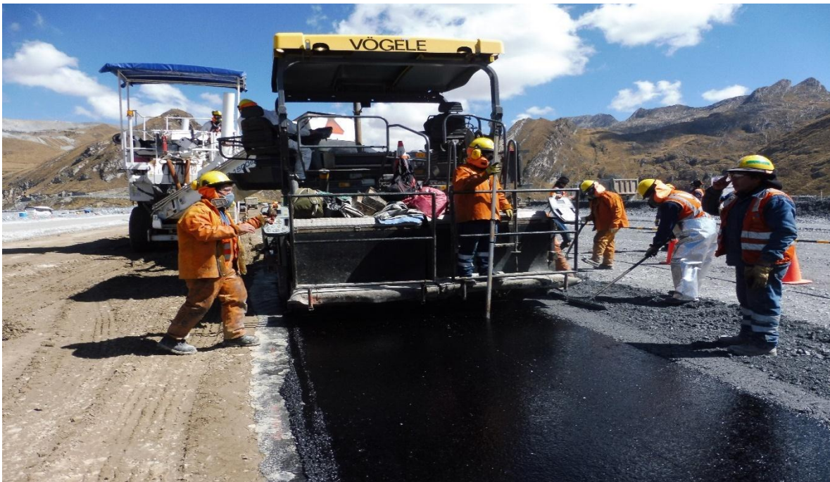
Figura 25: Se visualiza la colocación del concreto asfáltico, y el control de espesor de capa.
