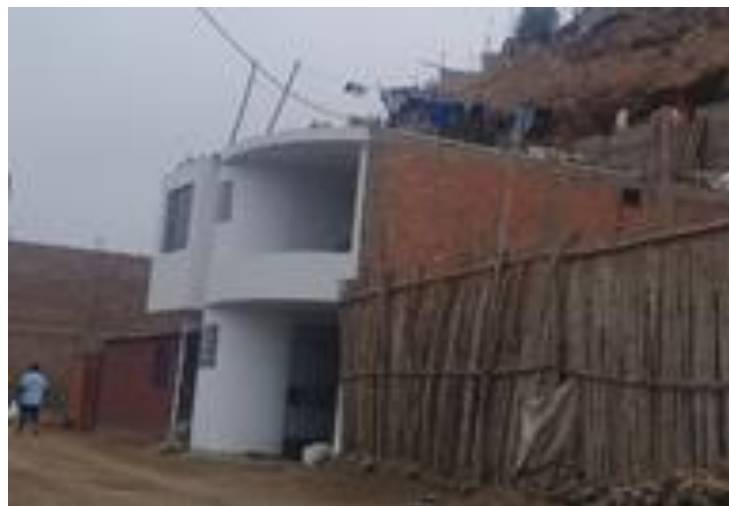
Figura N° Vivienda V1, presenta un volado en su fachada.
