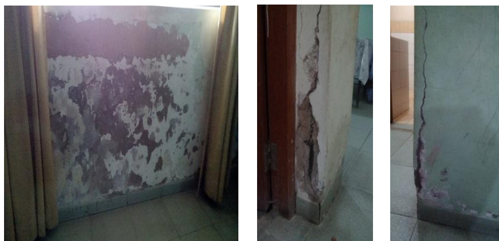
Figura I, 1: Eflorescencia en muros de albañilería y corrosión del acero en elemento estructural (columna). Fuente: Elaboración propia.
