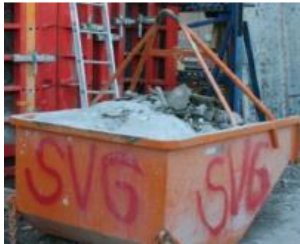
Figura 13 Balde Basculante de Grúa Torre
