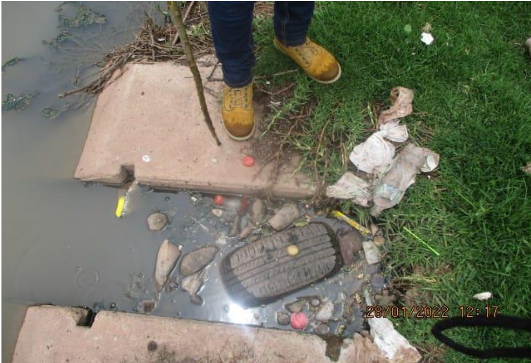
Figura 29 Obstrucción con basura uno de las líneas de conducción de aguas servidas
