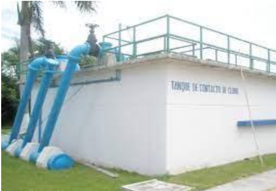
Figura 27 Cámara de cloración
