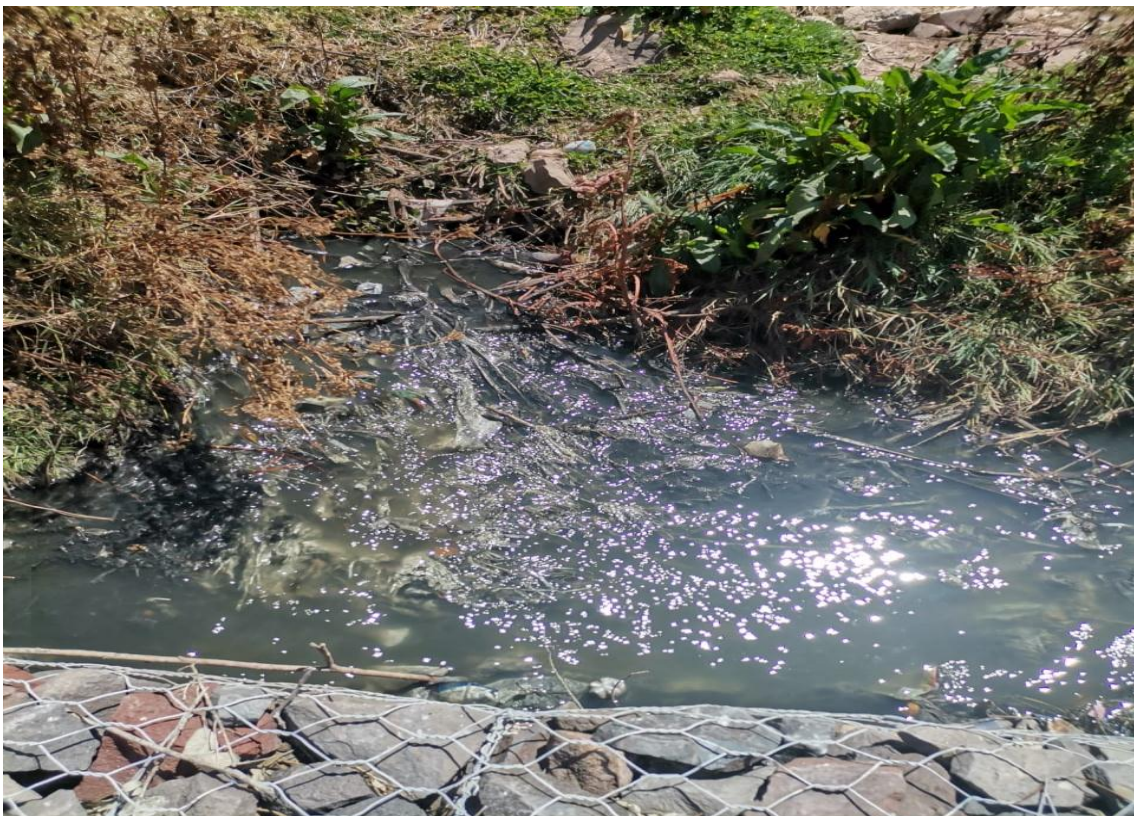
Figura 30 Aguas servidas filtradas de las laguna de estabilización
