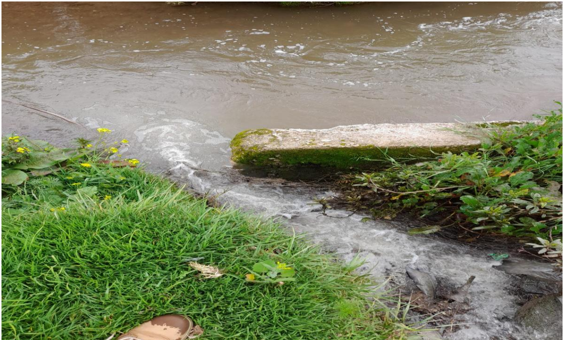
Figura 33 Efluente final siendo vertido al rio Yanamayo
