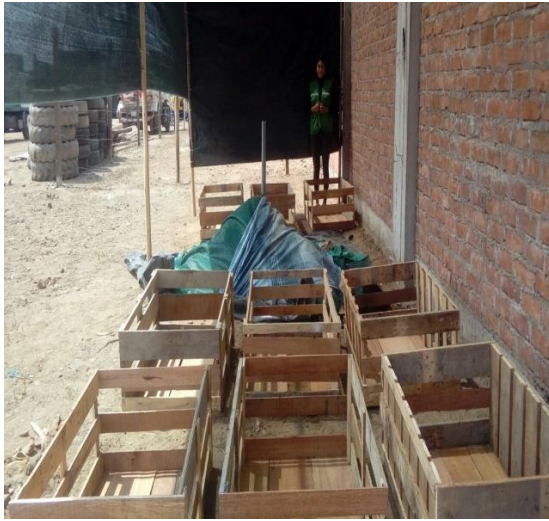
Fotografía N° 34. Distribución de las cajas composteras Fuente: Propia
