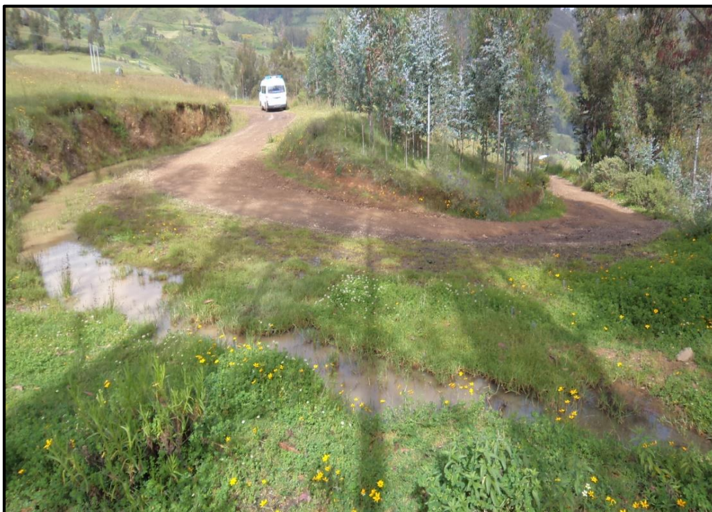
Anexo N° 3 Carretera deteriorada con agua de lluvias empozada a un costado de la vía.
