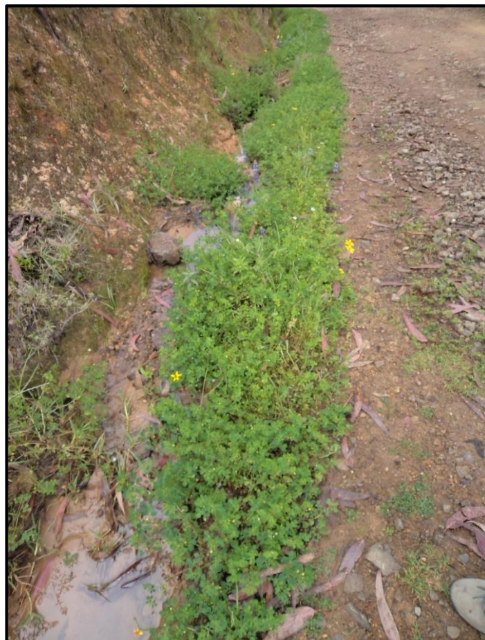
Anexo N° 11 Agua empozada de las lluvias por la inexistencia de cunetas.
