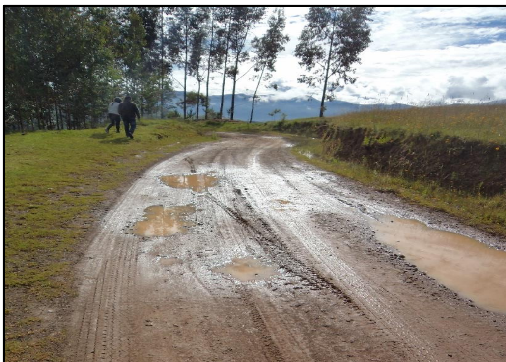
Anexo N° 4 Charcas de agua lo que produce el hundimiento de la carretera.
