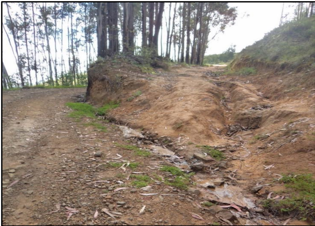
Anexo N° 5 Hundimiento de lado de la carretera.
