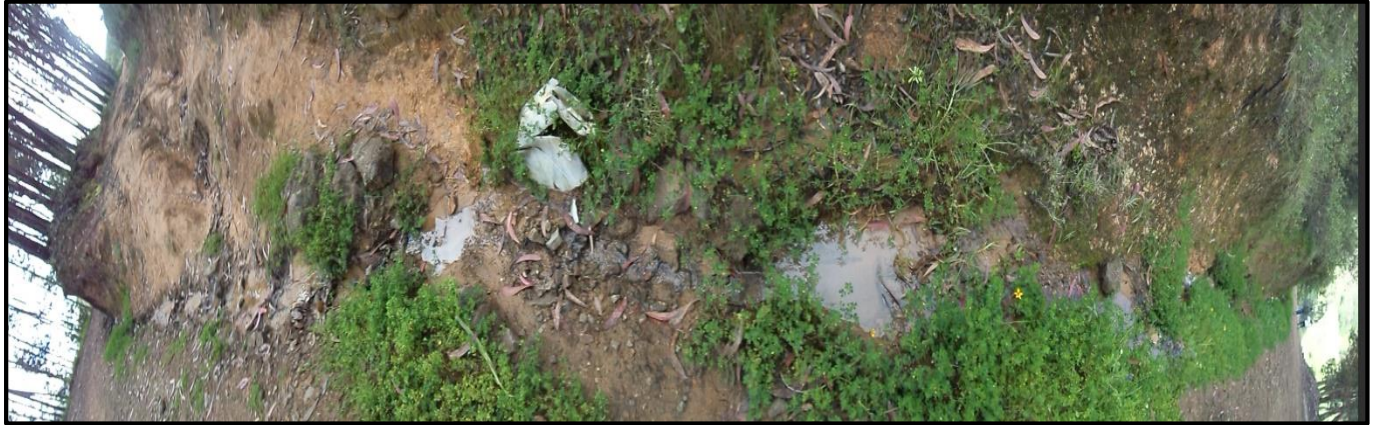
Anexo N° 10 Hundimiento y agua empozada al costado de la vía.
