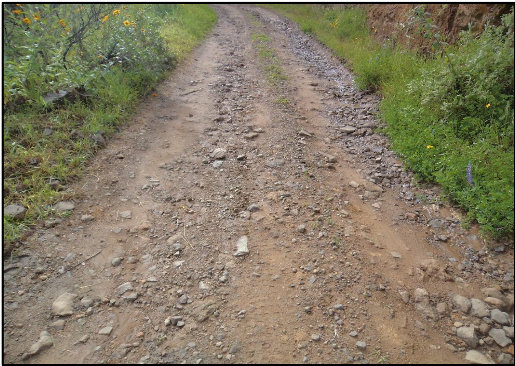
Anexo N° 8 Alta presencia de piedras sueltas en la pista.
