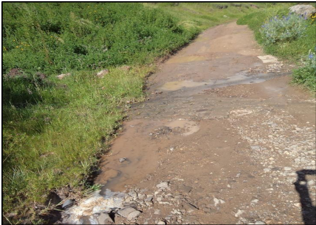
Anexo N° 6 Filtración del agua lo cual deja a la carretera insegura para la transitabilidad vehicular.
