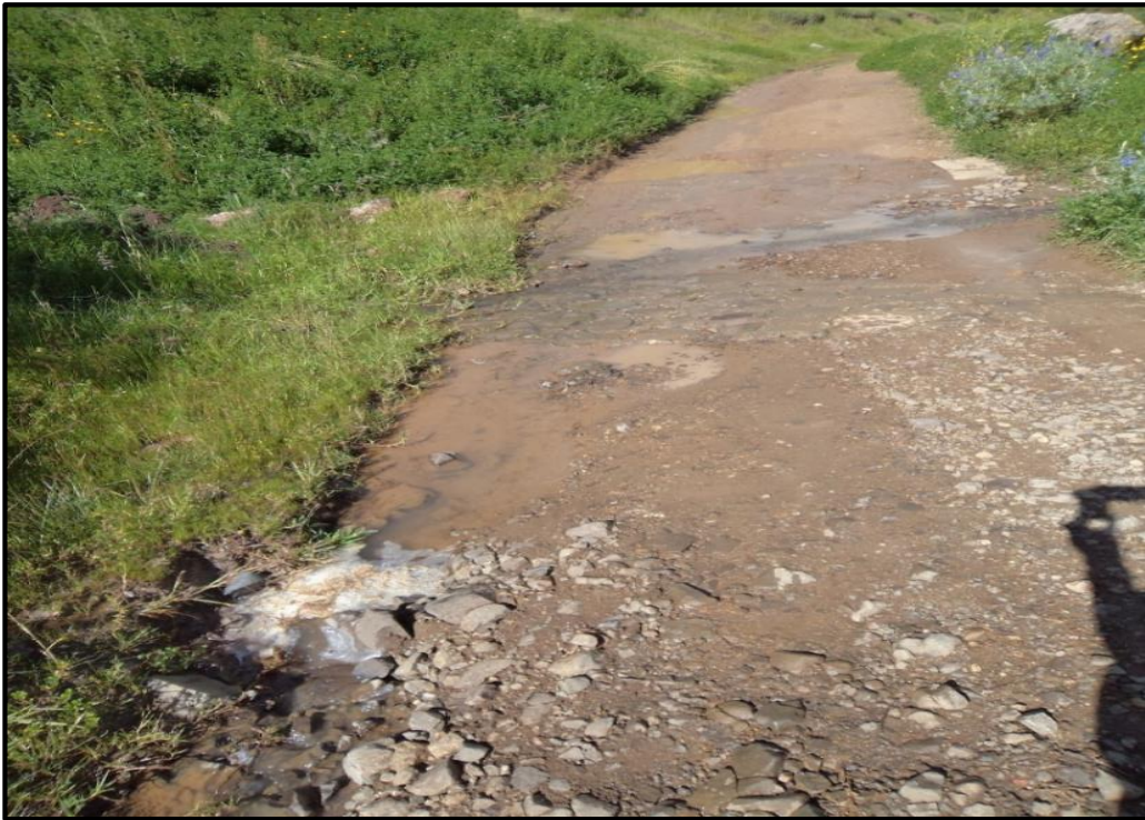
Anexo N° 12 Filtración del agua lo cual deja a la carretera insegura para la transitabilidad vehicular.
