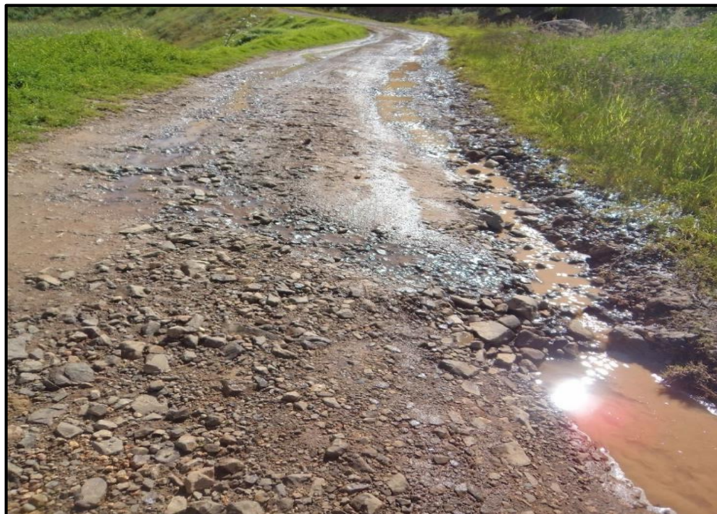
Anexo N° 5 Presencia de lodo debido a la combinación de la tierra de la carretera y el agua de las lluvias.
