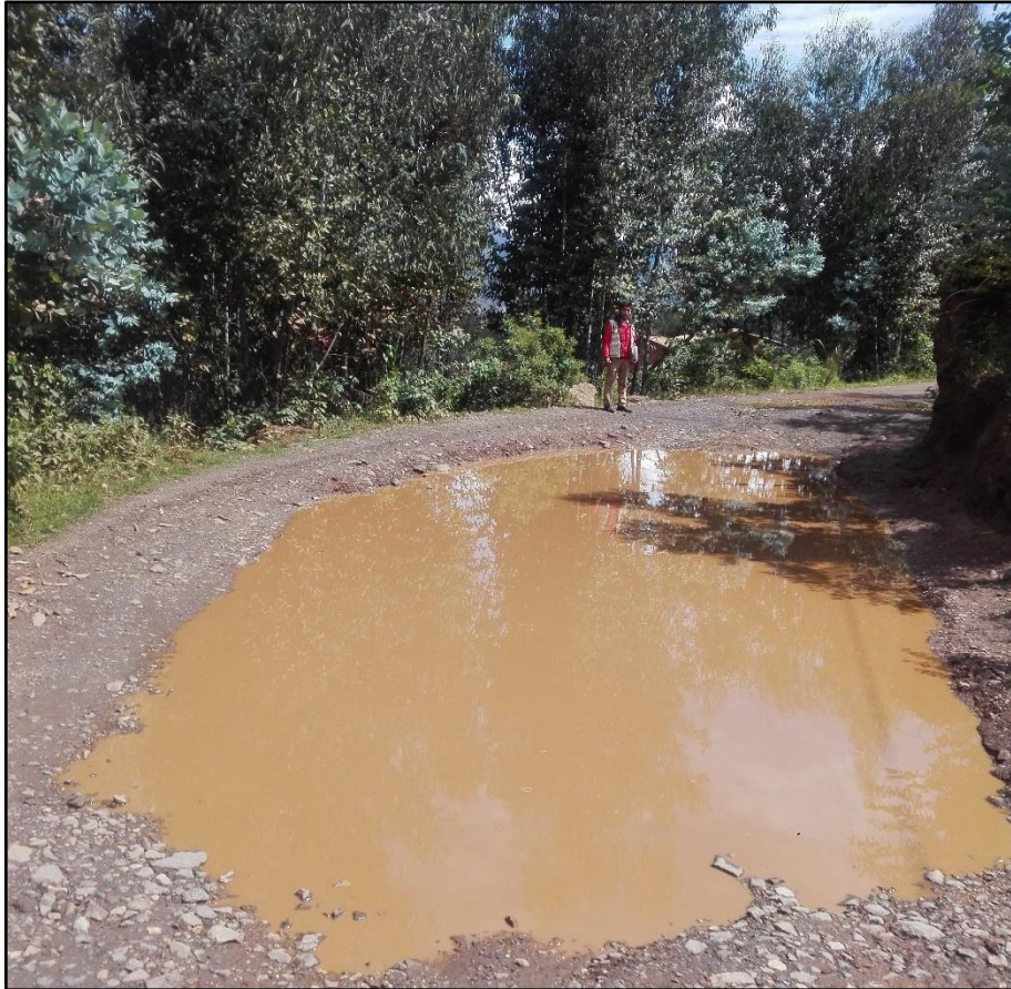
La falta de obras de arte en la vía hace que se almacene aguas de lluvias en la carretera.
