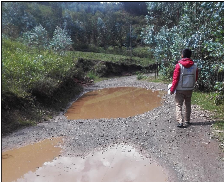
Acumulación de agua en carretera
