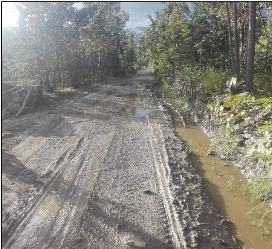
La falta de obras de arte en la vía hace que se almacene aguas de lluvias, ocasionando charcos de lodo en la carretera.
